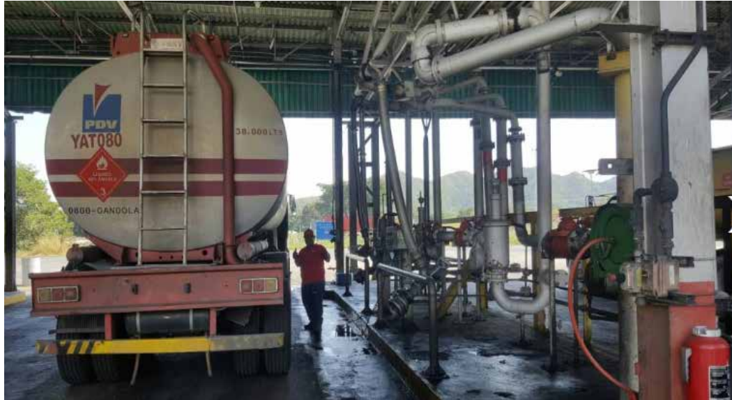
Figura 14: Proceso de llenado de las gandolas cisternas Fuente: Planta Distribuidora PDVSA Yagua. (2018)
