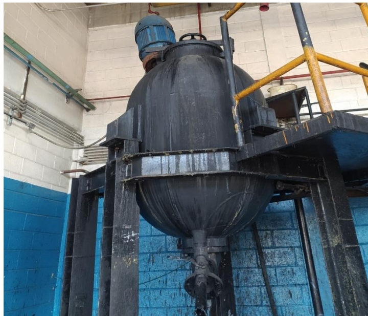
Mezcladores de casa de cemento
