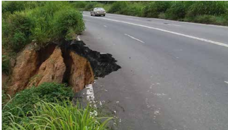
Figura 08: Falla de borde en Troncal 11
