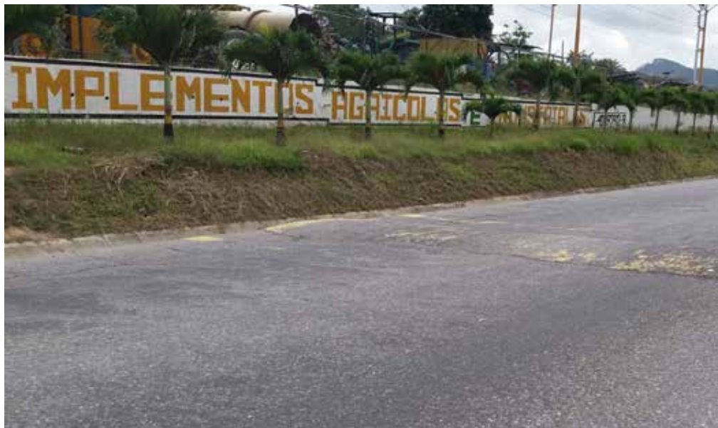
Figura 11: Corrugamientos en el pavimento de la troncal 11
