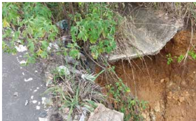
Figura 02: Fallas en drenajes de troncal 11 en tramo de Carabobo
