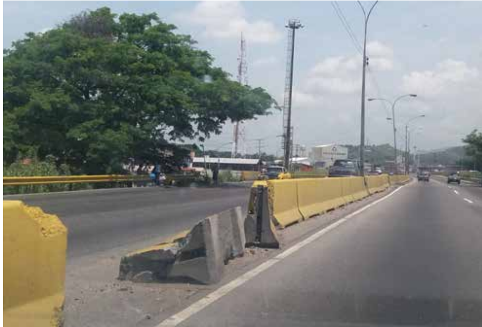
Figura 04: Fallas en defensas centrales de la troncal 5 en el tramo del edo.
