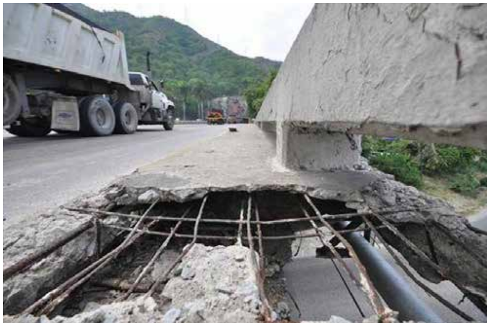
Figura 07: Estado actual del puente La Cabrera
