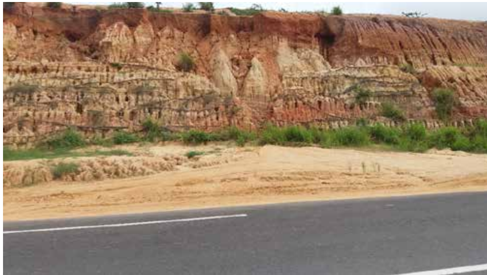
Figura 10: Derrumbe en taludes de la Autopista Cimarron Andresote
