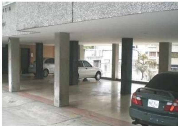
Figura 2.9. Ausencia de vigas altas en las dos direcciones.
