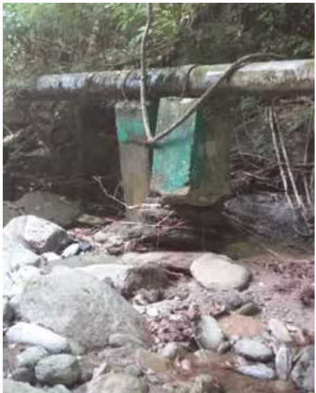
Figura 15. Anclaje Deteriorado Fuente: Azuaje, Nuñez (2020)
