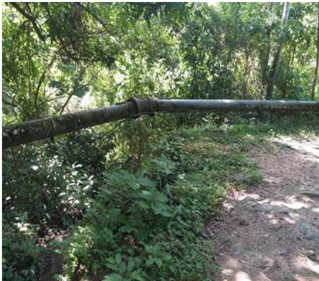
Figura 16. Tubería sin Anclaje. Fuente: Azuaje, Nuñez (2020)
