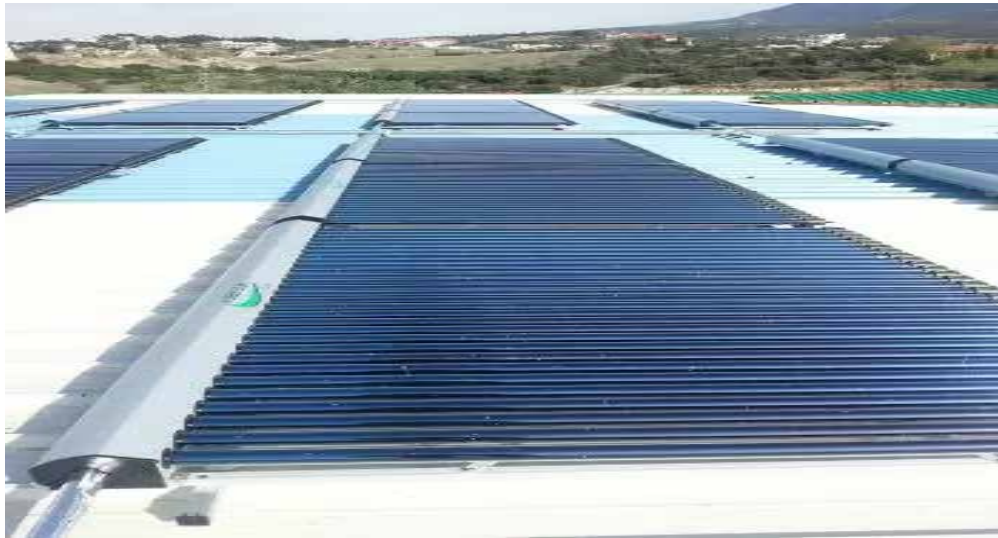
Figura 3. Arreglo solar térmico Fuente. https://solar-energia.net/
