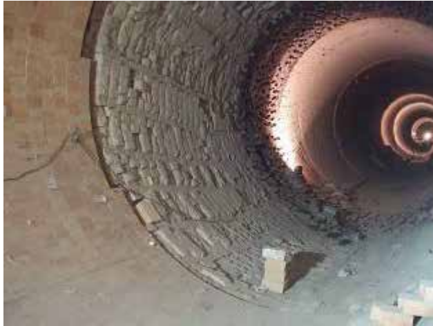
Figura 4. Revestimiento Interno de ladrillos refractarios
