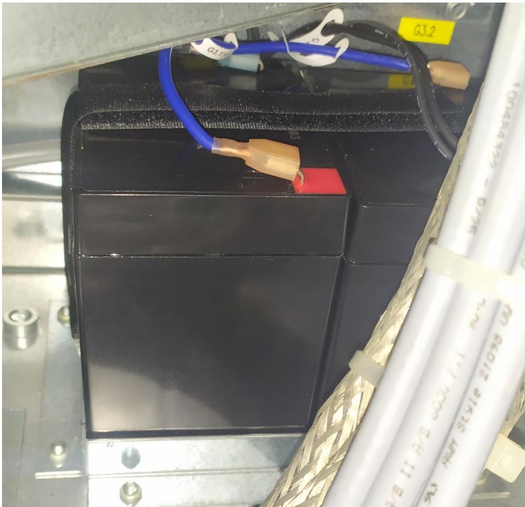
Figura 31: Baterías nuevas de la unidad de control del robot KUKA KR180. Fuente: Alenza, M. (2023).
