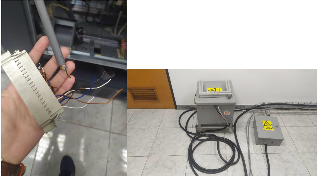
Figura 2: Parte de las conexiones perdidas en la unidad de control y en el subsistema de energía del robot KUKA KR180 R3200 PA.
