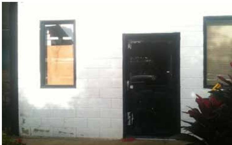
Figura 10: Falta de Seguridad.
