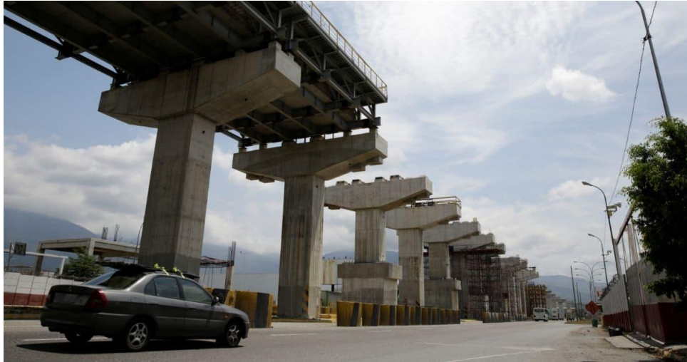
Figura 5: Construcción de red ferroviaria nacional inconclusa
