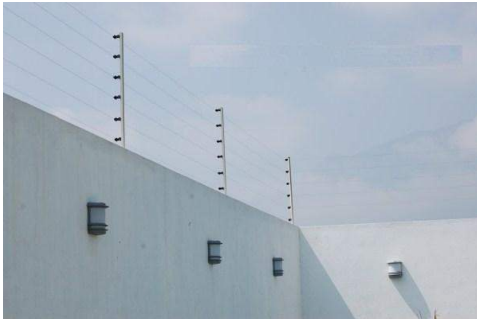
Figura Nro. 6 Cerco eléctrico
