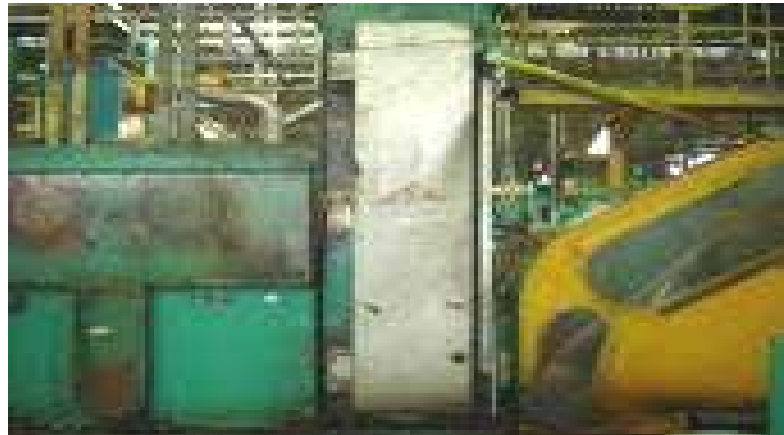
Figura 5. Cámara de Enfriamiento
