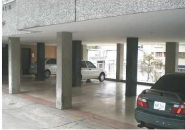
Figura 9 Ausencia de vigas altas en las dos direcciones.
