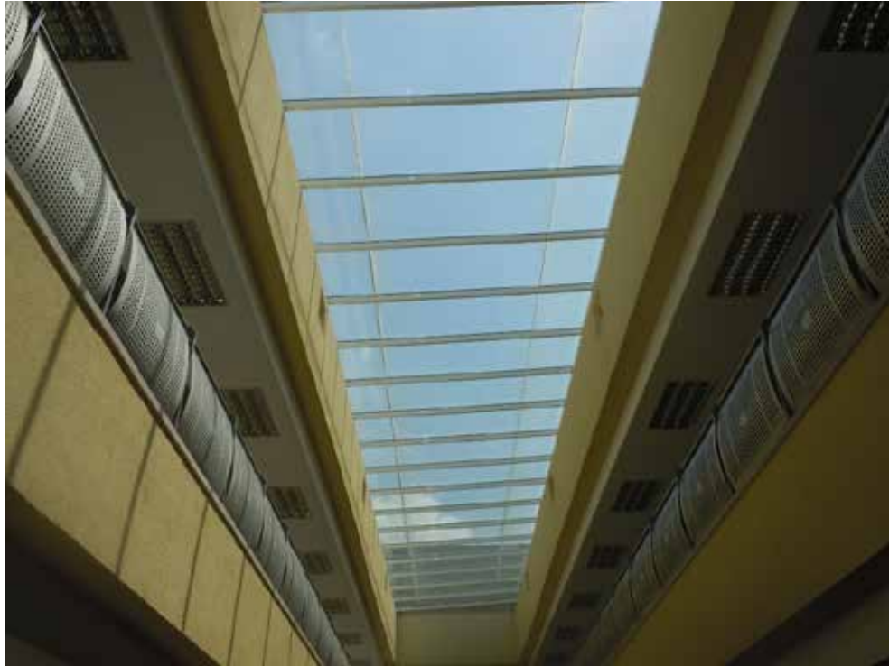
Abertura en techo.
