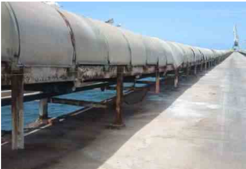
Figura 41: Capotes instalados en serie a lo largo del recorrido de la cinta Fuente: Ynfante 2019.
