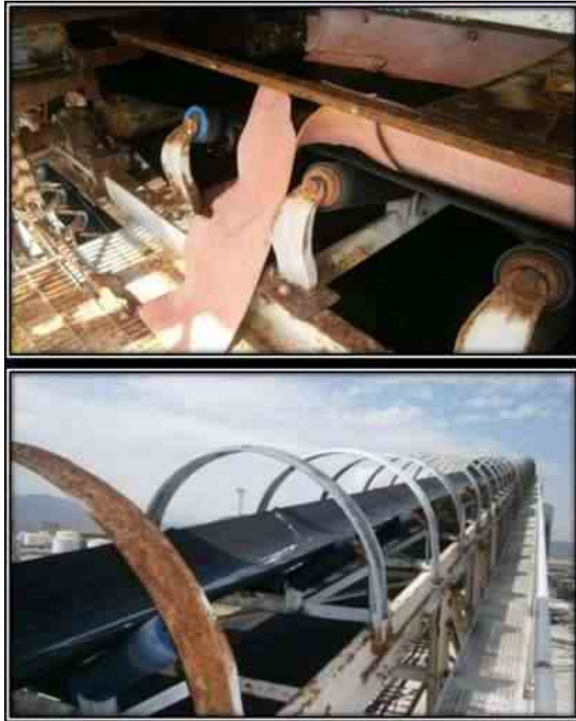
Figura 42: Falta de hermetizar el sistema de transición.
