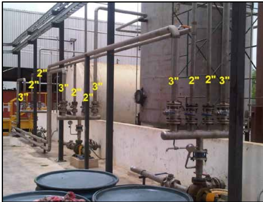
Figura 5 Manifold de del sistema de pesaje.
