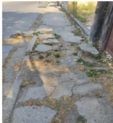
Caminería con grietas y maleza Autores: González y Torres (2023)
