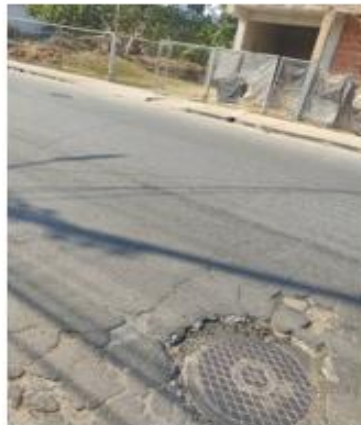
Piel de cocodrilo, hundimiento de la boca de visita. Autores: González y Torres (2023)
