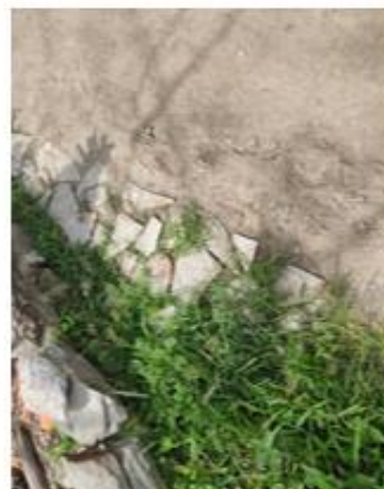
Falta de caminerías y cunetas Autores: González y Torres (2023)
