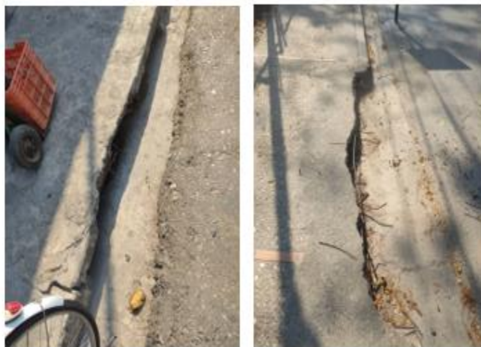
Figura 27 Drenaje con acero expuesto. Autores: González y Torres (2023)
