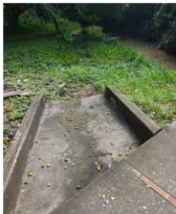
Babero de descarga hacia la quebrada del Rio San Diego. Autores: González y Torres (2023)
