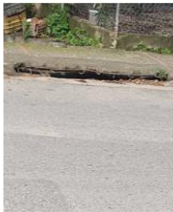
Sumidero con acero expuesto Autores: González y Torres (2023)
