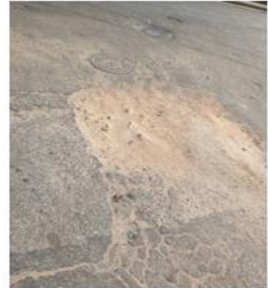
Disgregación del material. Autores: González y Torres (2023)
