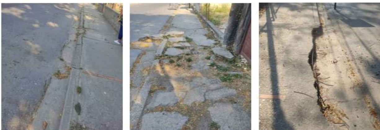
Figura 10 Fallas de borde y deterioro de caminería. Autores: González y Torres (2023)
