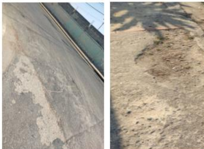
Figura 25 Disgregación de material.
