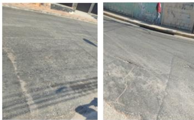
Figura 22 Grieta por bloque.
