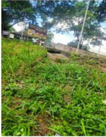
Maleza existente en el puente Autores: González y Torres (2023)
