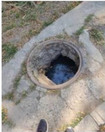
Boca de Visita sin Tapa de la calle Rondón. Autores: González y Torres (2023)
