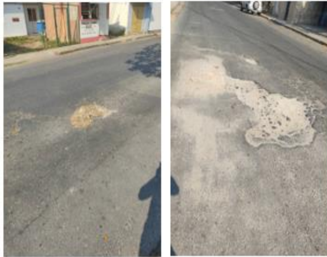
Figura 24 Falla de Hueco.
