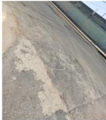
Piel de cocodrilo, disgregación de material. Autores: González y Torres (2023)
