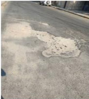
Disgregación de material, hueco de la calle Rondón. Autores: González y Torres (2023)
