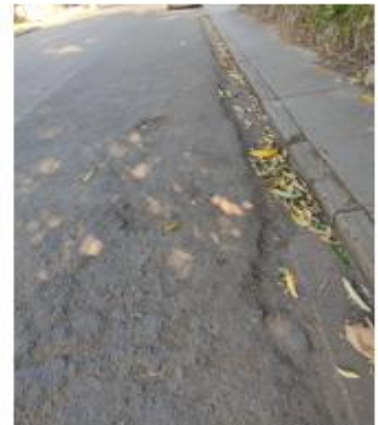
Disgregación del material, falla de borde Autores: González y Torres (2023)
