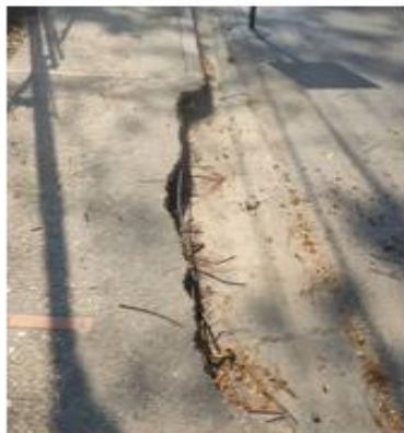
Sumidero de ventana con acero expuesto de la calle Rondón. Autores: González y Torres (2023)
