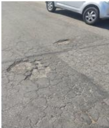
Piel de cocodrilo, hueco de la calle Rondón. Autores: González y Torres (2023)
