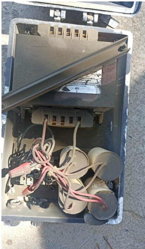
Figura 25. Sistema de encendido de las luminarias
