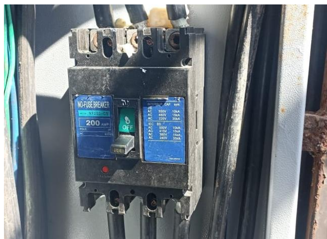
Figura 39. Sistema de protección para luminarias en pórtico.
