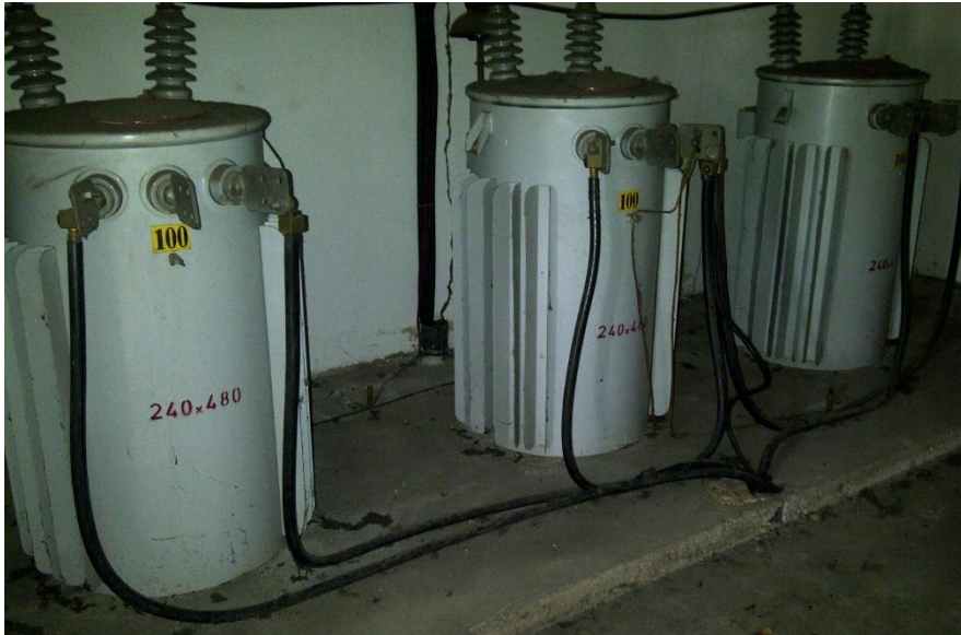
Figura 29. Transformadores de media a baja tensión presentes en el cuarto eléctrico
