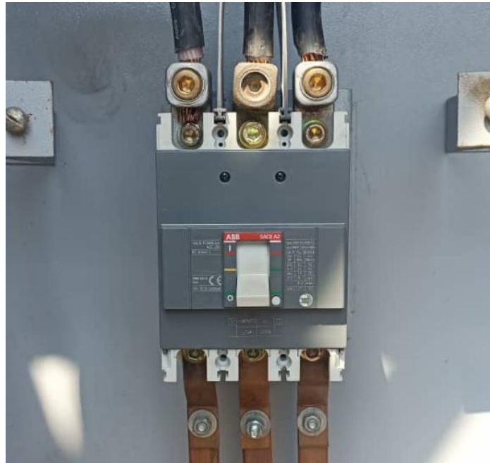
Figura 36. Breaker de tablero de distribución en pie de torre
