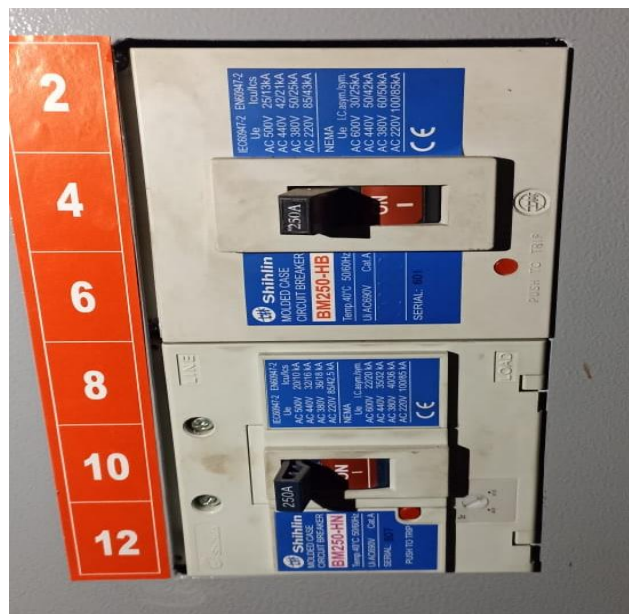
Figura 32. Breakers secundarios ubicados en centro de mando principal
