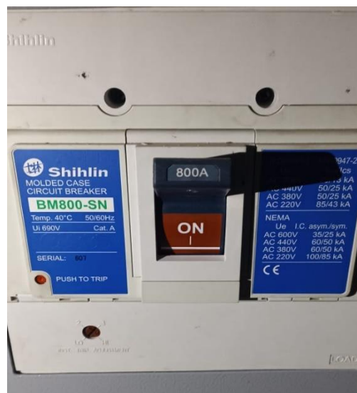
Figura 30. Breaker principal ubicado en el cuarto de transformación
