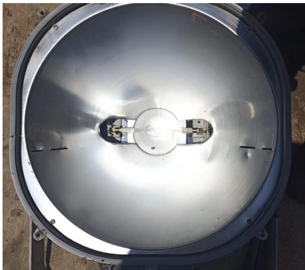
Figura 24. Luminaria desmantelada la cual no posee bien instalado el fleje ni la lámpara Fuente. Martínez A. (2023)
