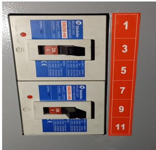
Figura 31. Breakers secundarios ubicados en centro de mando principal
