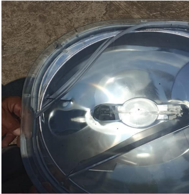
Figura 23. Luminaria desmantelada la cual no posee bien instalado el feje ni la goma Fuente. Martínez A. (2023)
