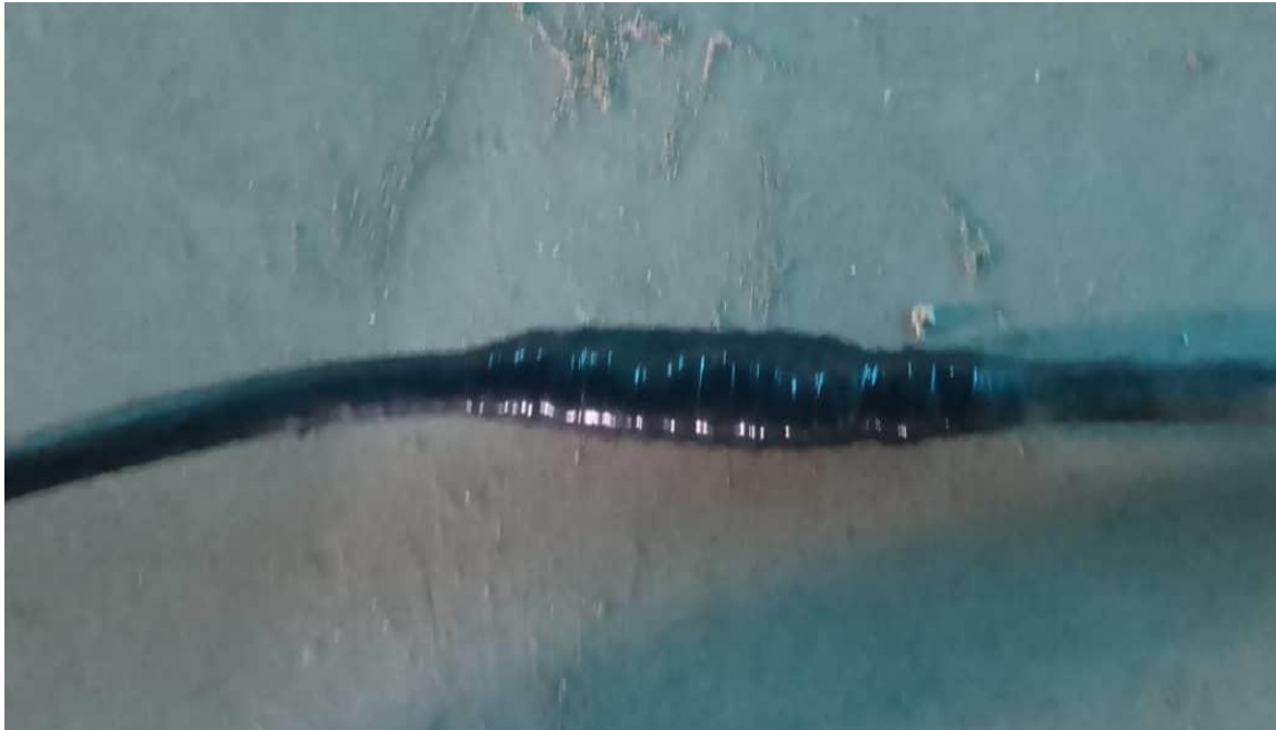
Figura 4. Proceso de recubrimiento de cable conductor con teipe por desgaste de chaqueta
