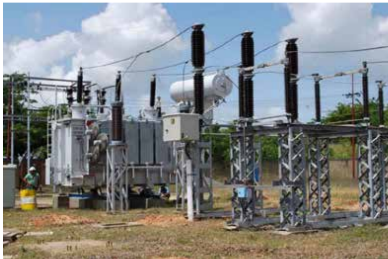
Figura 19: Subestación Guacara 2, municipio Guacara, estado Carabobo. Fuente: https://www.laranadigital.com/ejecutaran-labores-de-mantenimiento-este-sabado-en-subestacion-castillito-de-san-diego/ (2017)
