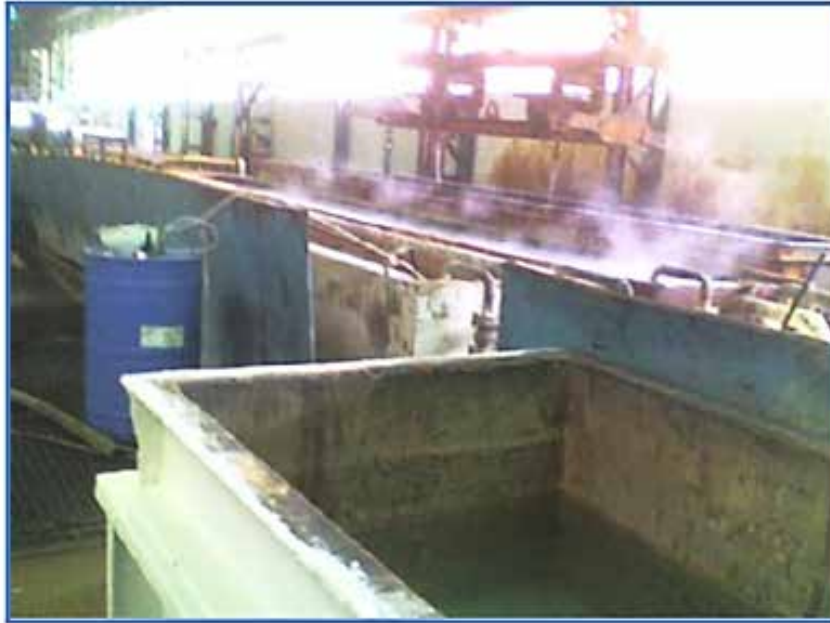
Figura 4 Tanques de tratamiento químico. Fuente: Propia (2019)
