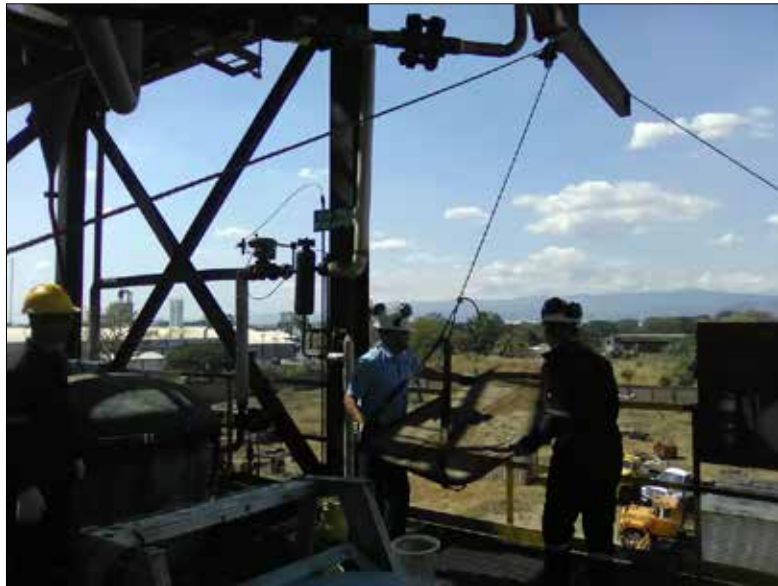
Figura 7. Descenso de las placas sacadas del filtro Fuente: Ruiz, J. (2020).
