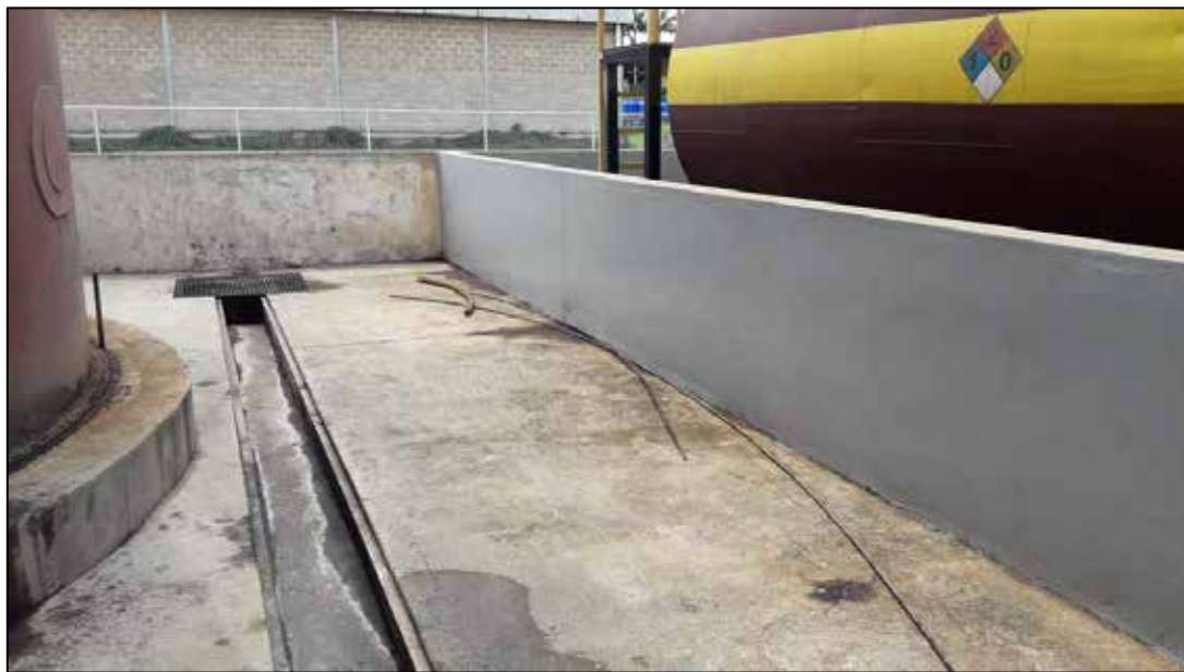
Figura 40. Área central de tanques de crudo.
