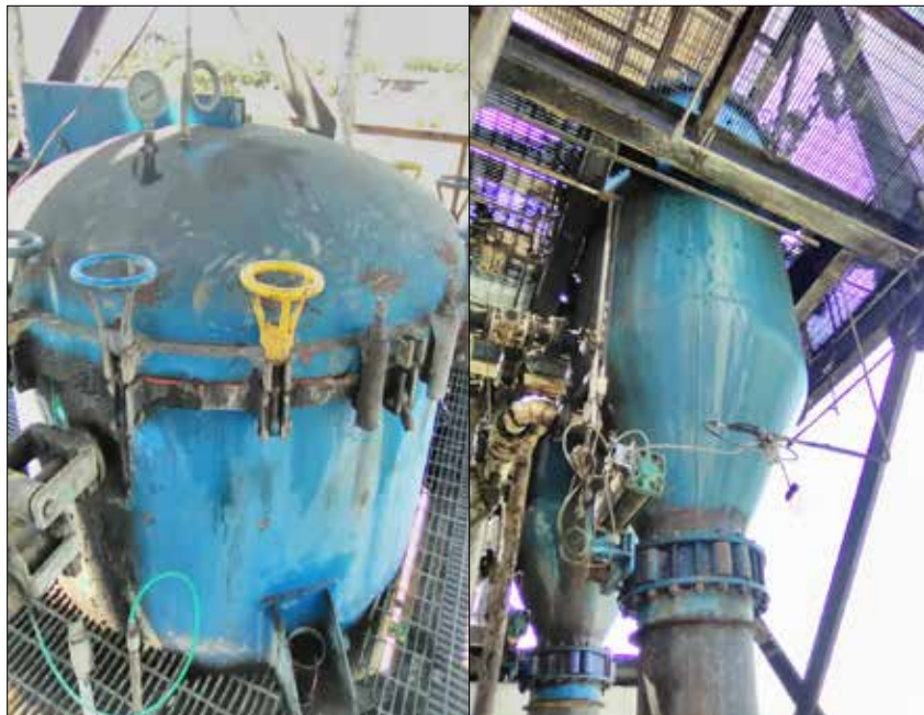
Figura 20. Parte superior e inferior de los filtros de placas verticales.
