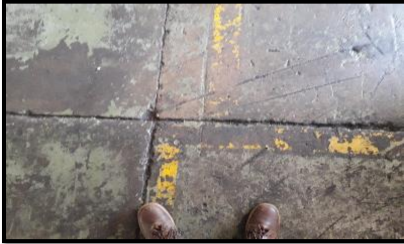
Figura 41: Rayado de almacenamiento degradado e inconsistente, Almacén de Producto Terminado de Tapas Corona. Autor: Carmona, G. (2019)
