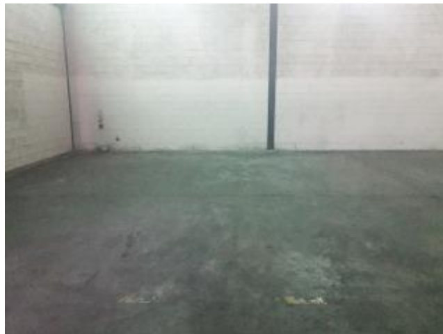
Figura 3: Almacén Externo, Rayado desgastado. Autor: Carmona, G. (2019)
