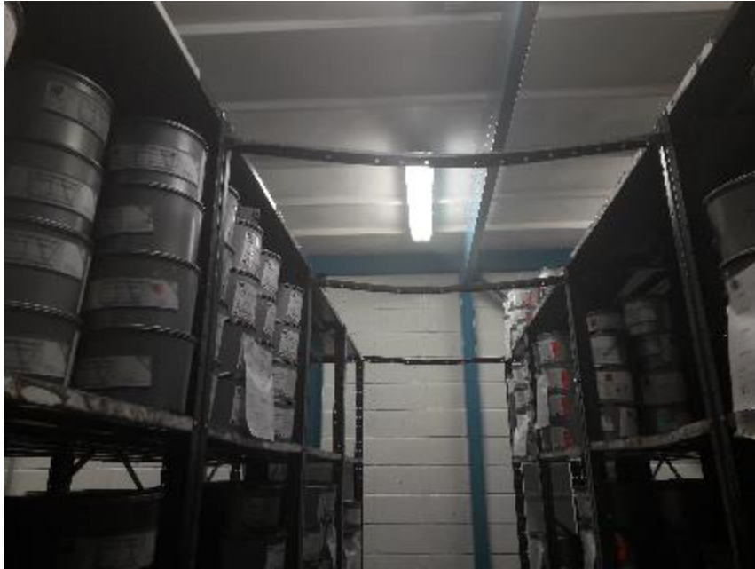
Figura 72: Deformaciones en Estantes del Almacén de Tintas de Tapas Coronas.
