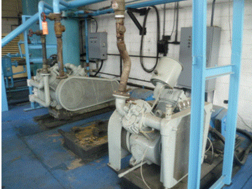
Anexo E Área de aire comprimido (ausencia de cabezal)
