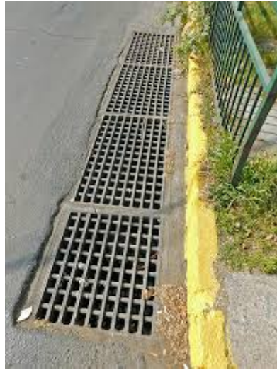
Figura 25. Sumidero de rejilla en cuneta.
