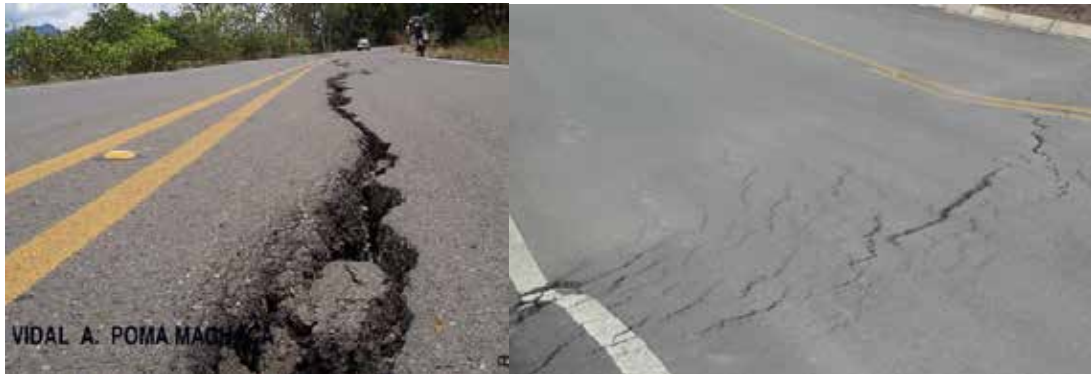
Figura 7. Grietas (Falla Estructural del pavimento Flexible). Fuente. [En línea]. Disponible en http://www.google.co.ve/labs.eie.ucv .
