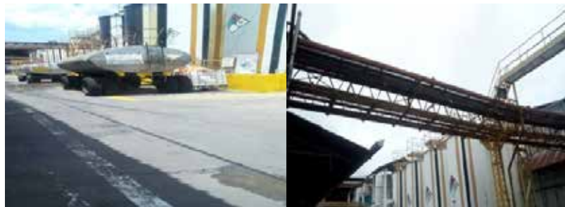
Foto N°3: Espacio de descarga Foto N°4: Tuberías a Planta
