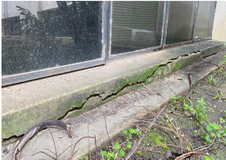
Gráfico 16. Desprendimiento del concreto en piso del área externa del Edificio I, de la Universidad José Antonio Páez.
