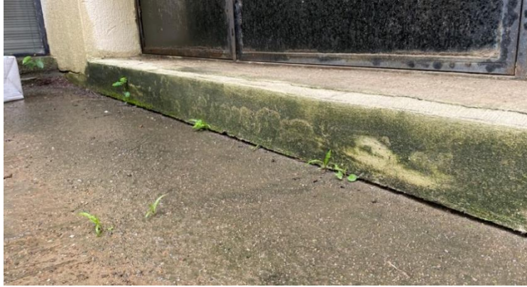
Gráfico 22. Grieta en piso del área externa del Edificio I, de la Universidad José Antonio Páez.
