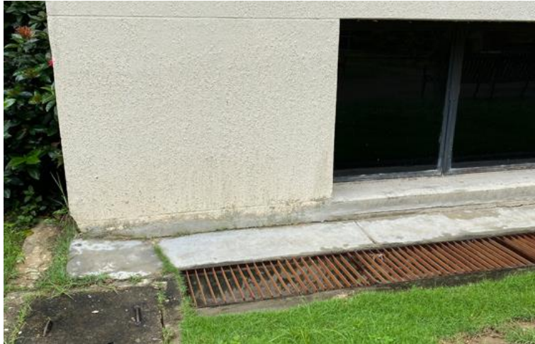
Gráfico 26. Grieta en piso del área externa del Edificio I, de la Universidad José Antonio Páez.
