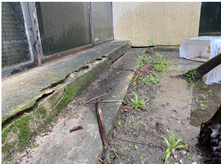
Gráfico 20. Desprendimiento del concreto en piso del área externa del Edificio I, de la Universidad José Antonio Páez.
