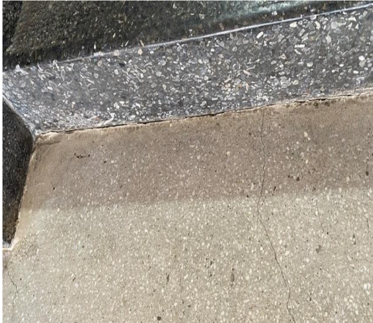
Gráfico 12. Grieta en el piso del área interna del Edificio I, de la Universidad José Antonio Páez.
