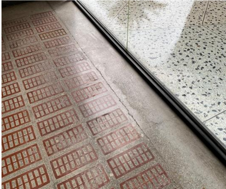
Gráfico 14. Grieta en el piso del área interna del Edificio I, de la Universidad José Antonio Páez.
