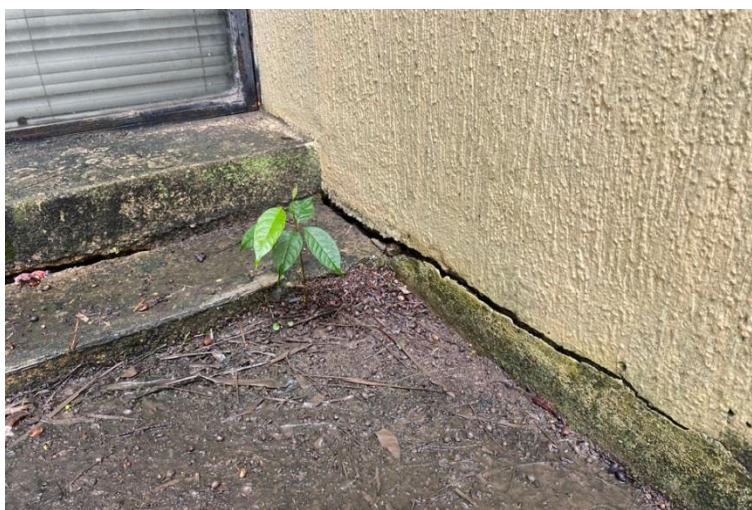
Gráfico 21. Desprendimiento del concreto en piso del área externa del Edificio I, de la Universidad José Antonio Páez.
