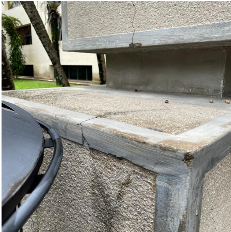
Gráfico 17. Grieta en columna del área externa del Edificio I, de la Universidad José Antonio Páez.
