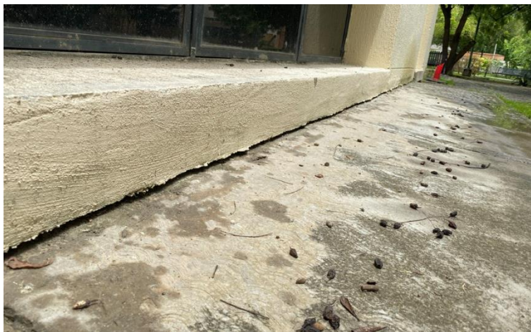
Gráfico 23. Grieta en piso del área externa del Edificio I, de la Universidad José Antonio Páez.
