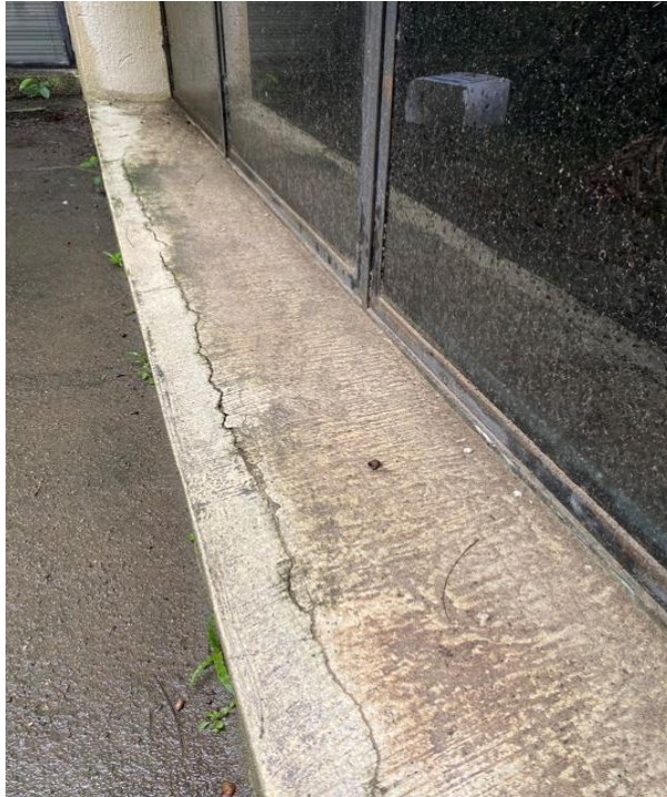
Gráfico 10. Grieta y humedad en el piso del área externa del Edificio I, de la Universidad José Antonio Páez.
