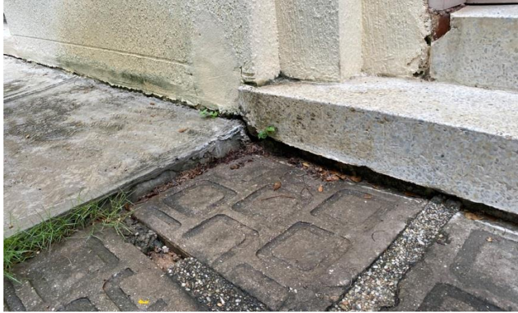
Gráfico 24. Desprendimiento del concreto en área externa del Edificio I, de la Universidad José Antonio Páez.
