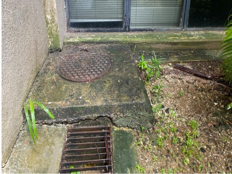
Gráfico 18. Desprendimiento del concreto en el piso del área externa del Edificio I, de la Universidad José Antonio Páez.
