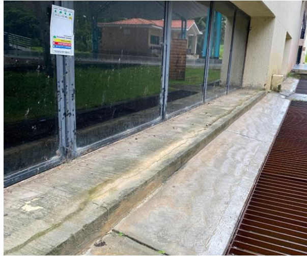
Gráfico 8. Grieta y humedad en el piso del área externa del Edificio I, de la Universidad José Antonio Páez.
