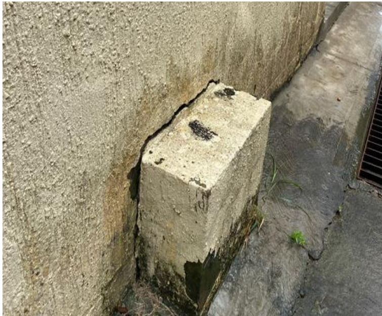
Gráfico 13. Grieta y humedad en el área externa del Edificio I, de la Universidad José Antonio Páez.
