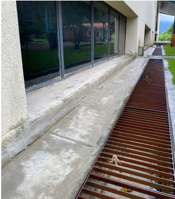
Gráfico 7. Grieta y humedad en el piso del área externa del Edificio I, de la Universidad José Antonio Páez.
