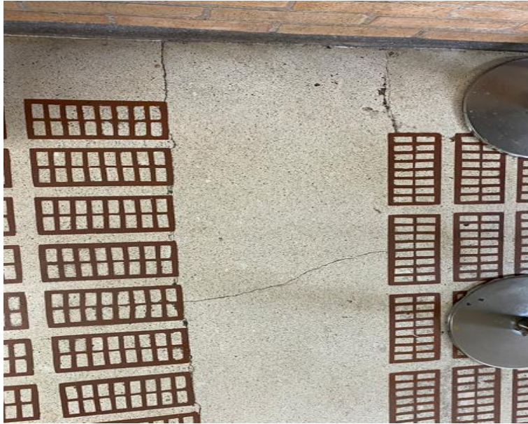
Gráfico 28. Grieta en piso del área interna del Edificio I, de la Universidad José Antonio Páez.
