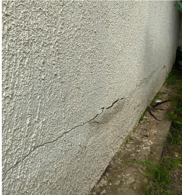
Gráfico 6. Grieta y humedad en la pared del área externa del Edificio I, de la Universidad José Antonio Páez.
