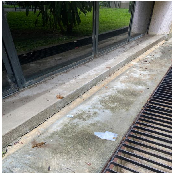
Gráfico 11. Grieta y humedad en el piso del área externa del Edificio I, de la Universidad José Antonio Páez.
