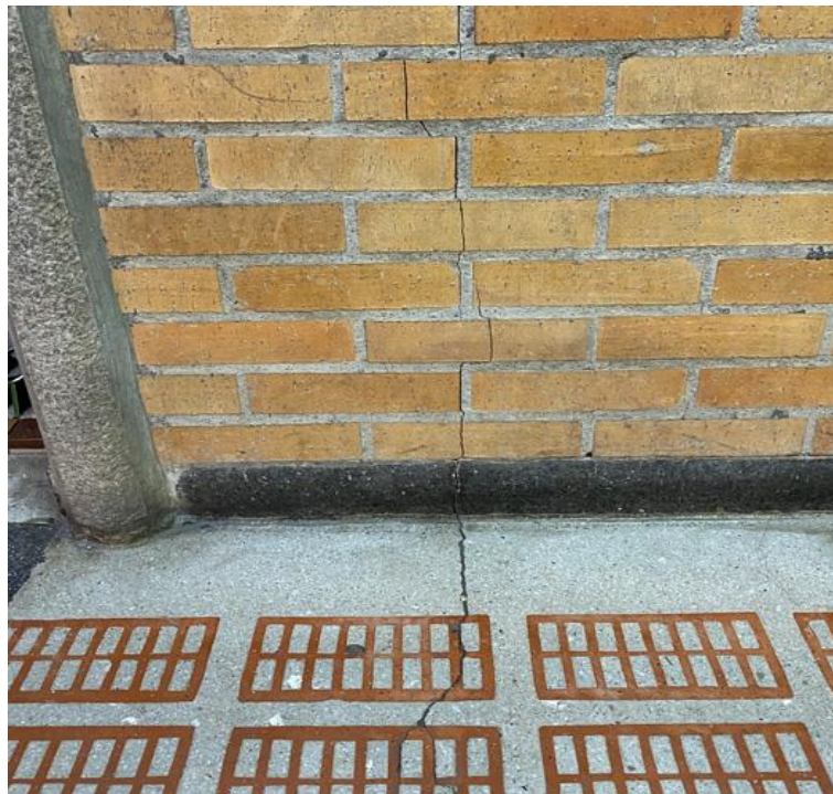
Gráfico 19. Grieta en pared y piso del área interna del Edificio I, de la Universidad José Antonio Páez.
