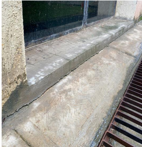
Gráfico 9. Grieta y humedad en el piso del área externa del Edificio I, de la Universidad José Antonio Páez.
