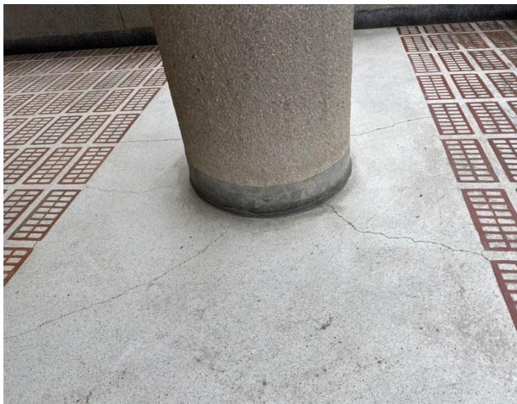
Gráfico 27. Grieta en piso del área interna del Edificio I, de la Universidad José Antonio Páez.
