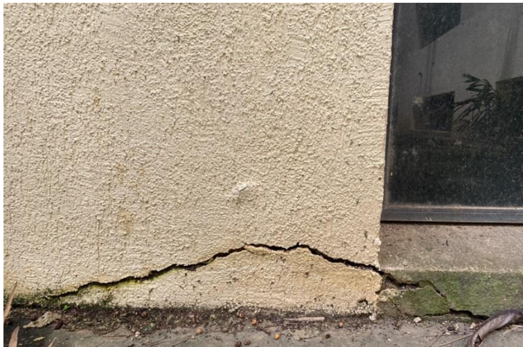
Gráfico 15. Desprendimiento del concreto en pared del área externa del Edificio I, de la Universidad José Antonio Páez.
