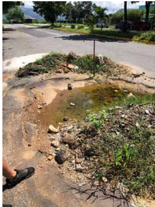
Figura 20: Hundimiento en el tramo H-I
