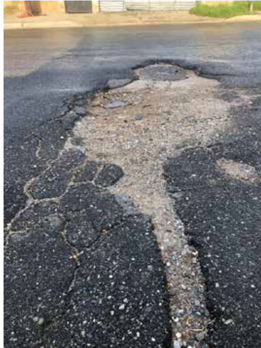
Figura 1: Falla en el tramo A-B
