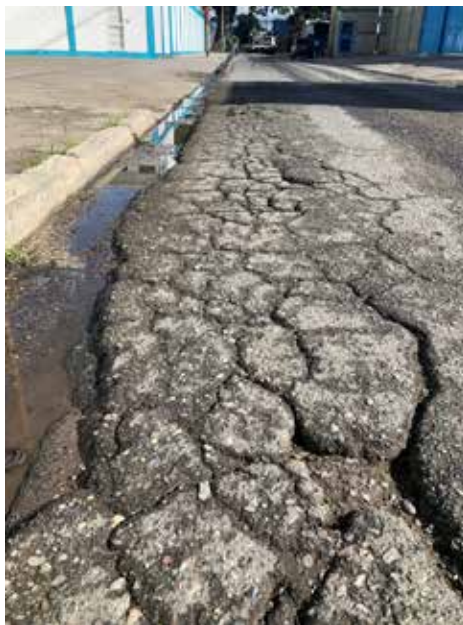
Figura 6: Piel de Cocodrilo en el tramo C-D
