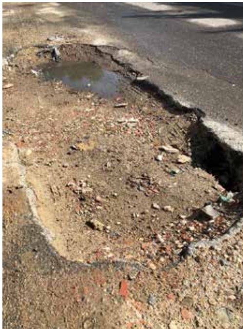
Figura 8: Hueco en el tramo C-D
