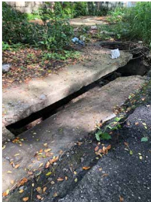
Figura 10: Deterioro en alcantarilla E-F
