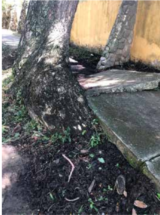
Figura 15: Levantamiento de acera en el tramo G-H
