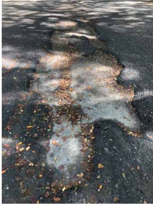
Figura 11: Disgregación en el tramo E-F
