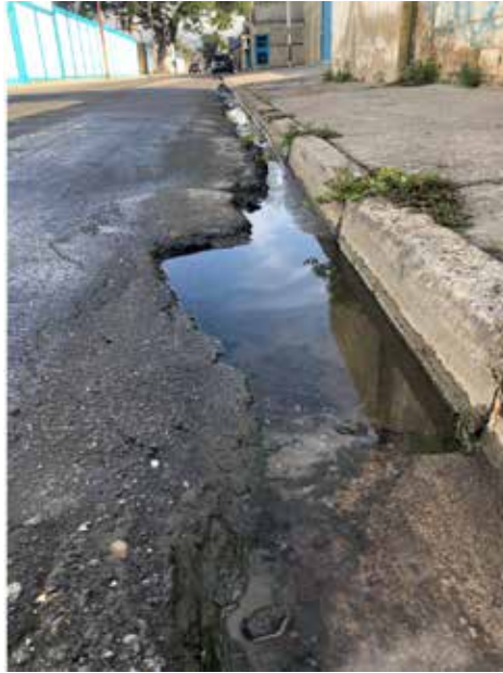
Figura 5: Falla de borde en el tramo C-D
