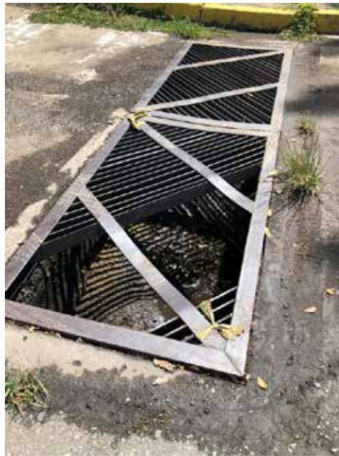
Figura 16: Deterioro en alcantarilla G-H
