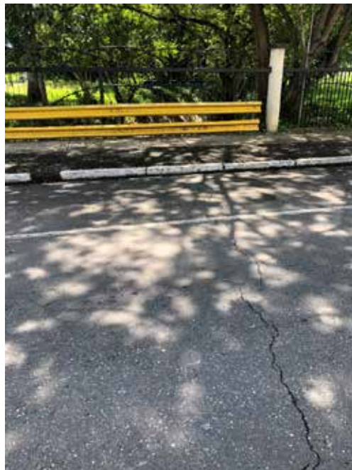
Figura 18: Falla transversal en el tramo H-I
