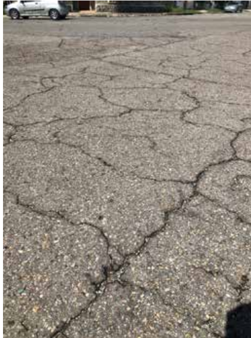
Figura 13: Falla de bloque F-G
