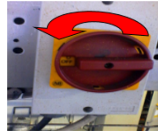
Imagen #6 Disconnect Switch
