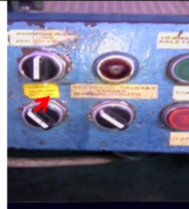
Imagen #14 Selector bomba elevador en "ON"
