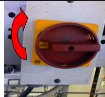
Imagen #8 Disconnect Switch
