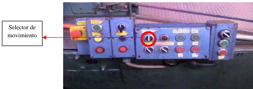
Figura 30 Selector de movimiento de las cadenas del transportador Autor: Ocanto, A (2017)
