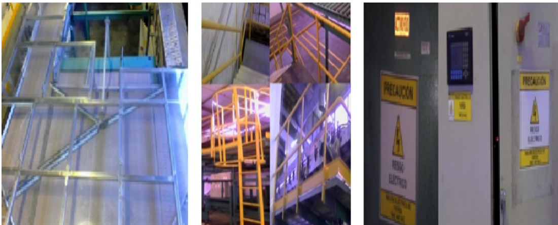
Figura 36Techo de transportadores/ Pasamanos y barandas
