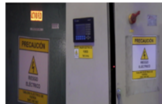
Imagen #3 Tablero eléctrico/Panel de control
