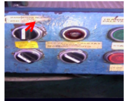
Imagen #15 Selector transportador de paletas llenas
