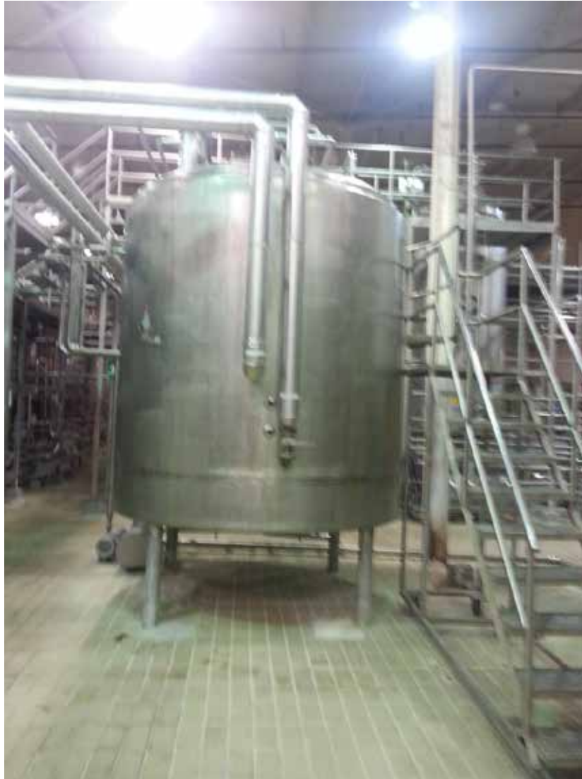
Figura 11. Tanque de Almacenamiento
