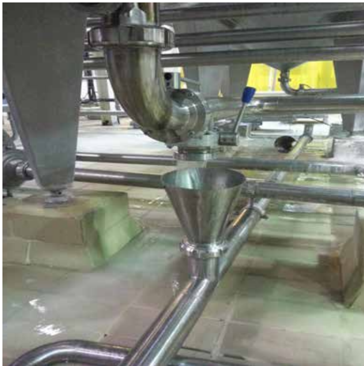
Figura 10. Válvula de Entrada al Tanque de Almacenamiento
