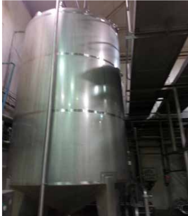
Figura 6. Tanque de Preparación
