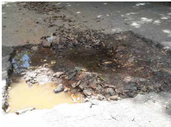
Figura 90. Falla por reparación de servicio.
