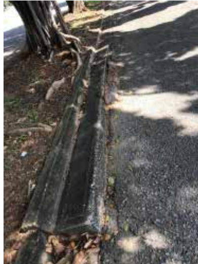
Figura 85. Falla por hundimiento en el tramo estudiado.
