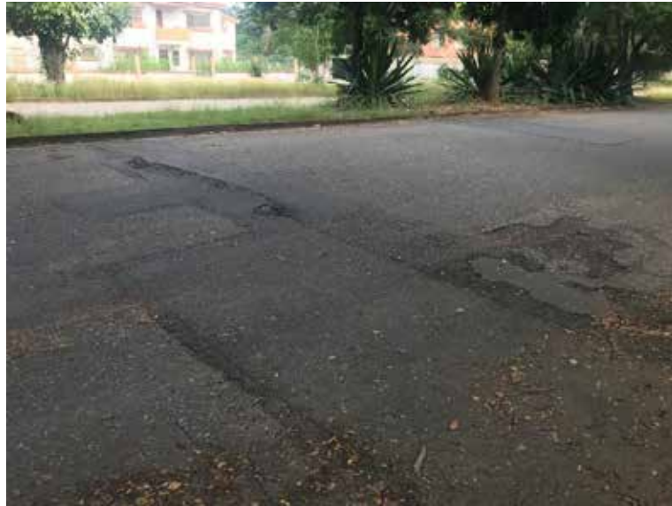
Figura 103. Falla por bacheo.
