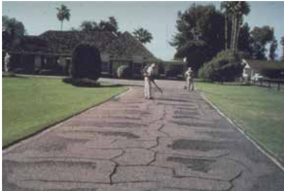
Figura 6. Grieta por bloque.
