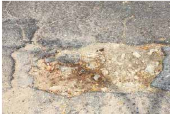
Figura 96. Falla de hueco.
