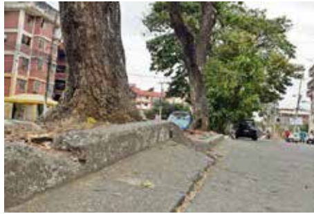
Figura 12. Falla por raíz de árbol.
