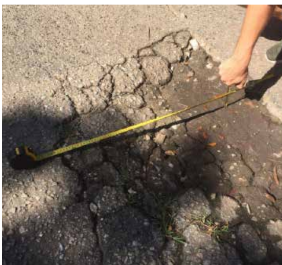
Figura 91. Falla por hueco y piel de cocodrilo.
