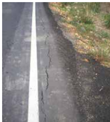
Figura 7. Grieta por borde.
