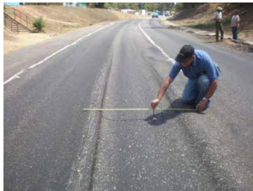
Figura 20. Falla por ahuellamiento.
