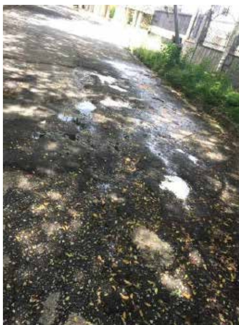
Figura 92. Falla por bache.
