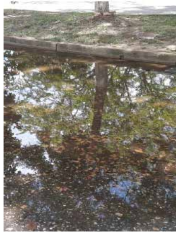
Figura 89. Falla por hundimiento en el tramo.
