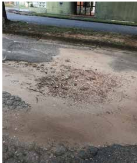
Figura 106. Falla por piel de cocodrilo y hueco.
