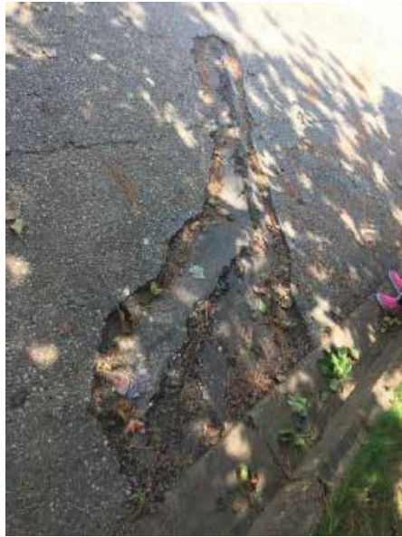
Figura 93. Falla por bache.
