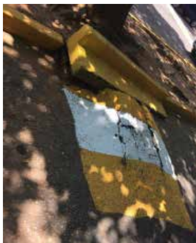
Figura 86. Falla por raíces de árboles en la progresiva estudiada.
