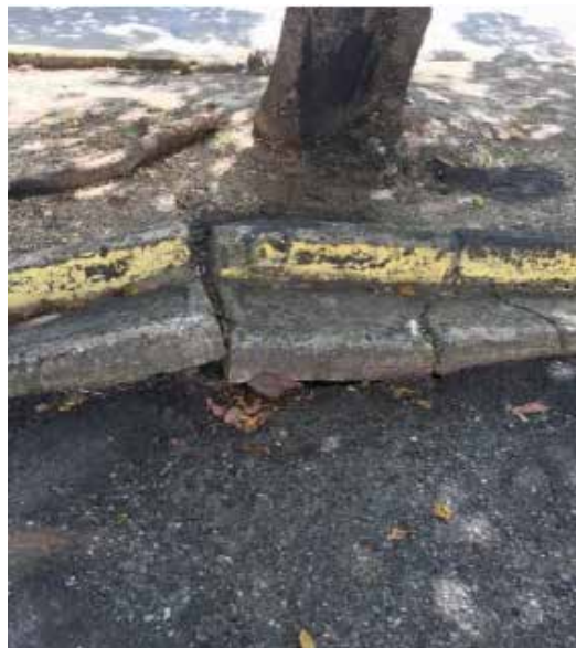
Figura 97. Falla por raíz de árbol.
