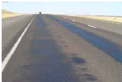
Figura 13. Mancha en pavimentos.
