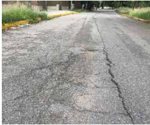
Figura 107. Hundimiento y grieta longitudinal.
