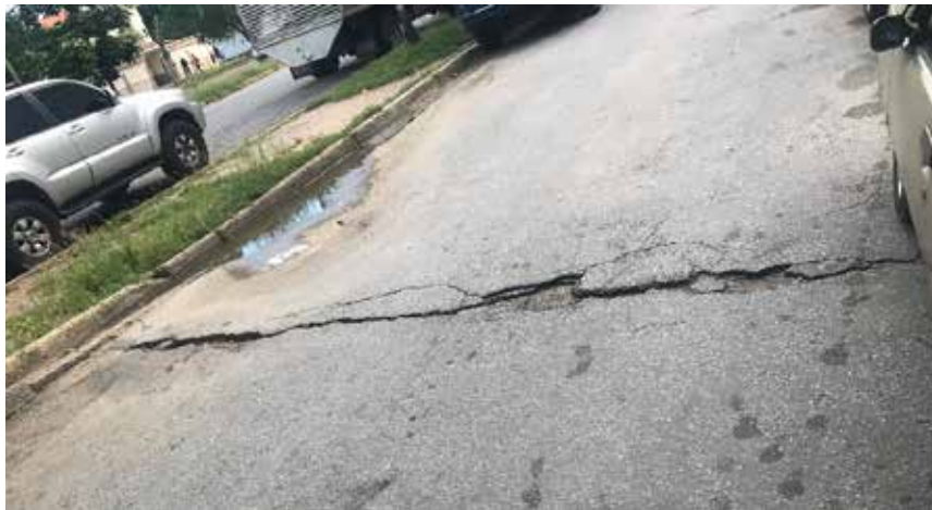
Figura 108. Hundimiento y grieta longitudinal.
