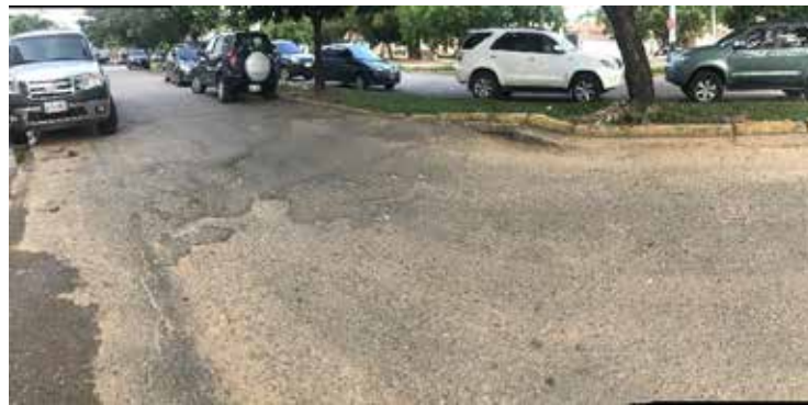
Figura 105. Falla por piel de cocodrilo y hueco.
