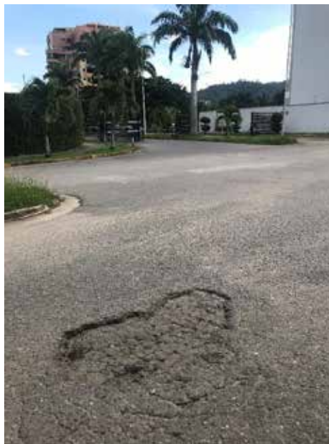
Figura 104. Falla por piel de cocodrilo y hueco.
