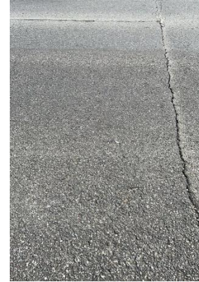
Grieta Longitudinal Puente V.De Oro Sur. Autores: Sanchez y Velásquez (2023)
