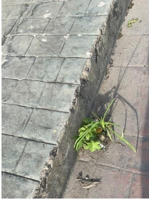
Drenaje obstruido, Puente V.De oro Norte. Autores: Sanchez y Velásquez (2023)
