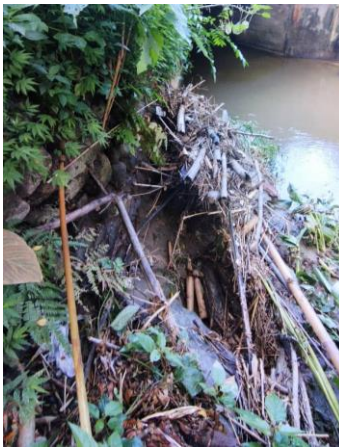
Acumulación de vegetación y sedimento, Puente Las Morochas. Autores: Sanchez y Velásquez (2023)
