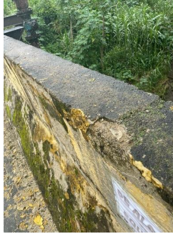
Deterioro de Vaya de seguridad vial, Puente Valle de Oro Norte. Autores: Sanchez y Velásquez (2023)
