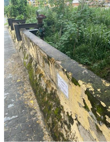
Deterioro de Vaya de seguridad vial, Puente Valle de Oro Norte. Autores: Sanchez y Velásquez (2023)
