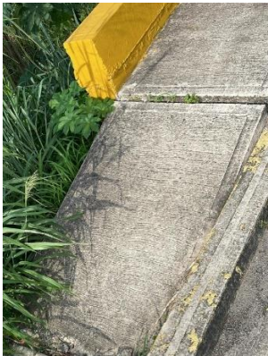
Descomposición de talud, Puente V.De Oro Sur. Autores: Sanchez y Velásquez (2023)
