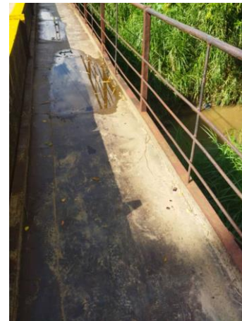
Paso peatonal en mal estado, Puente Los Tulipanes. Autores: Sanchez y Velásquez (2023)
