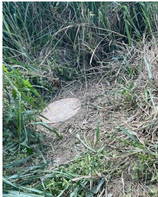
Boca de visita, Puente el Portal. Autores: Sanchez y Velásquez (2023)
