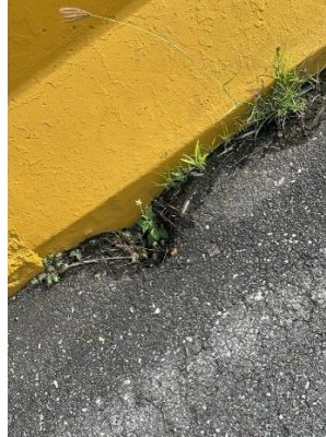
Drenaje obstruido, Puente La Joselina. Autores: Sanchez y Velásquez (2023)
