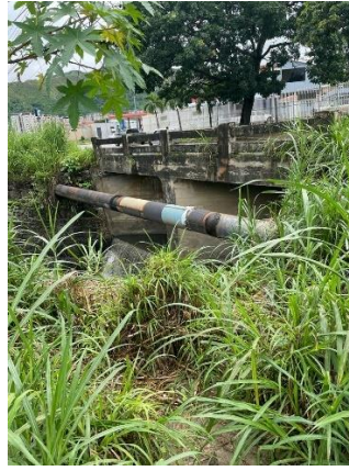
Vegetación sobre el Puente el Portal. Autores: Sanchez y Velásquez (2023)
