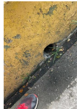
Drenaje obstruido, Puente Las Morochas. Autores: Sanchez y Velásquez (2023)
