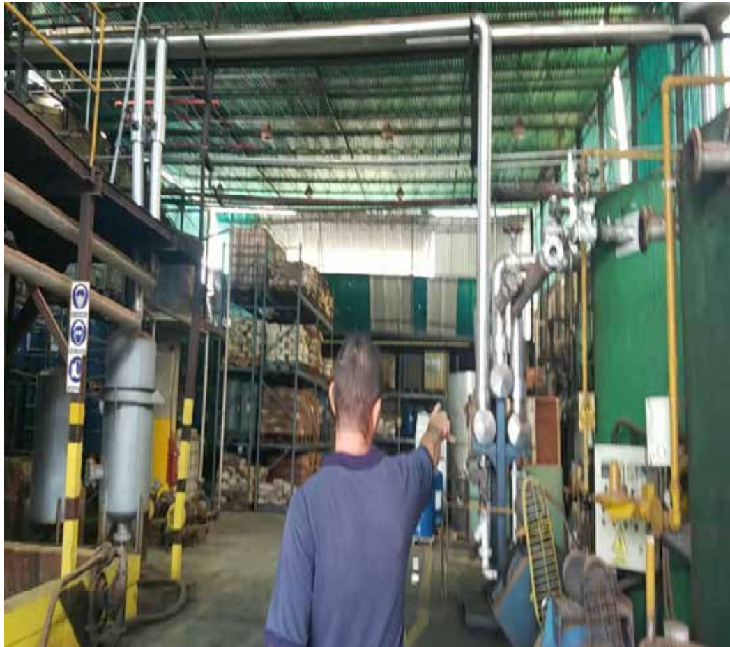
Figura 9. Obstaculización de pasillos por materiales diversos
