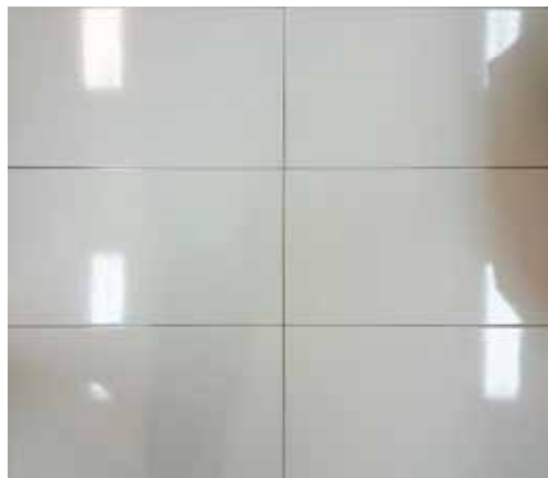
Figura 68. Cerámica nacional, acabado piso interno baños.
