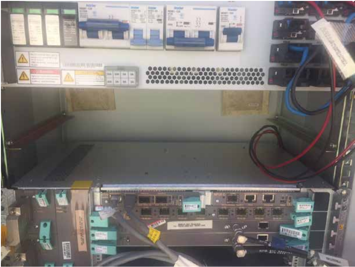
Equipos ubicados en el APM de la estación ZONA IND GUACARA
