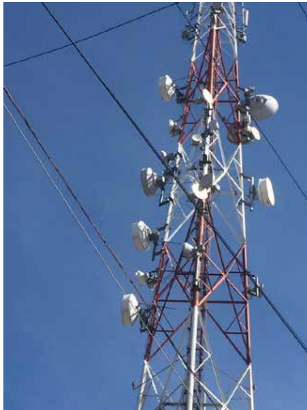
Figura 4: Torre de Comunicaciones estación Guacara
