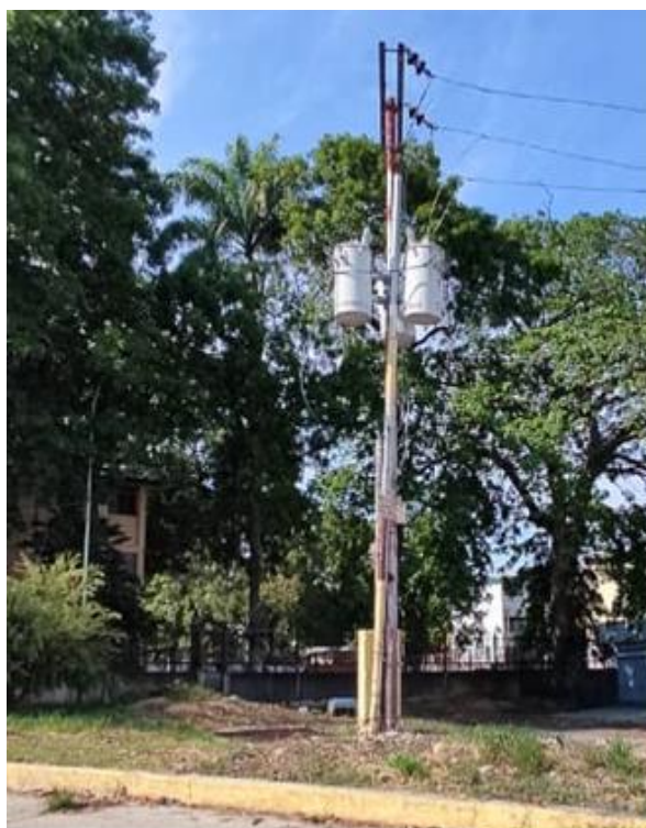
Figura 23. Servicio de electricidad. Fuente: La Autora (2023)
