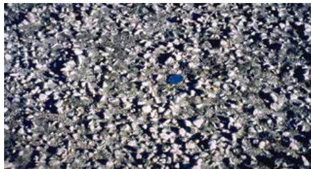
Figura 29: Disgregación y desintegración
