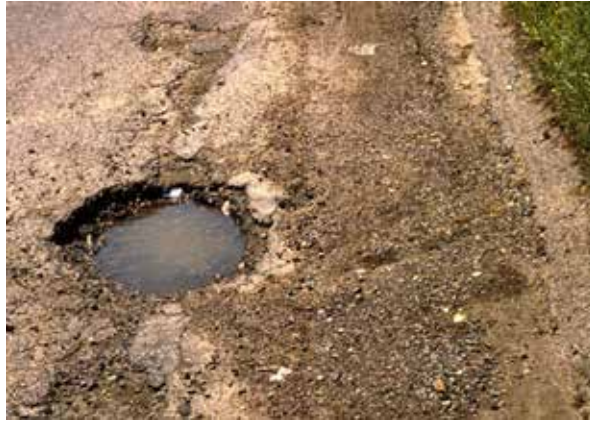
Figura 26: Falla tipo hueco, nivel de severidad alto. Fuente: Evaluación de pavimentos, Corredor G (2010).
