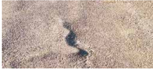
Figura 28: Falla tipo deformaciones por empuje.
