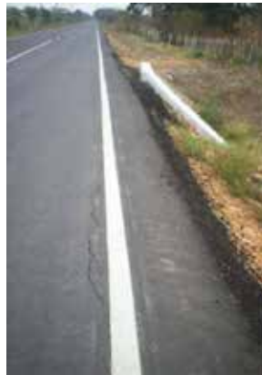
Figura 18: Falla tipo grieta de borde, nivel de severidad medio.
