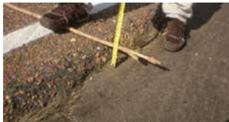
Figura 19: Falla tipo desnivel calzada hombrillo, nivel de severidad medio.
