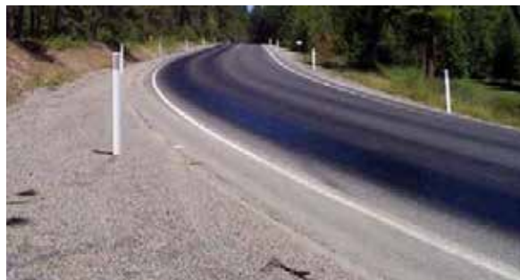
Figura 30: Exudación, nivel de severidad alto.
