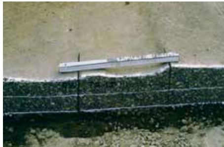
Figura 27: Falla tipo ahuellamiento. Fuente: Evaluación de pavimentos, Corredor G (2010).
