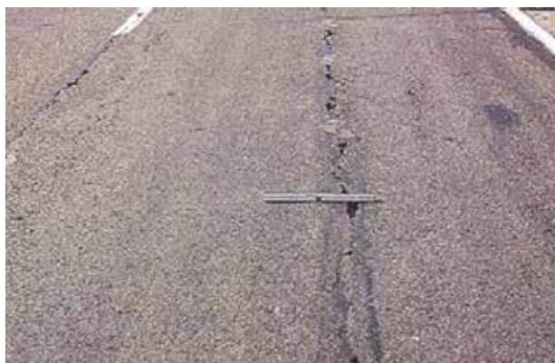
Figura 20: Falla tipo grietas longitudinales, nivel severidad medio.
