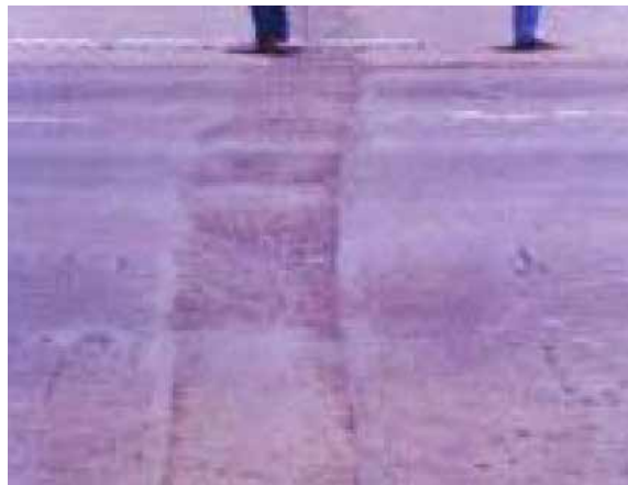
Figura 23: Bache moderadamente deteriorado
