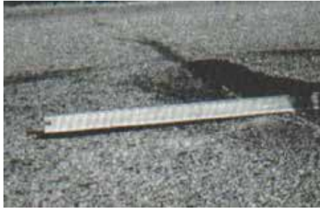
Figura 15: Falla tipo elevación, nivel de severidad alto
