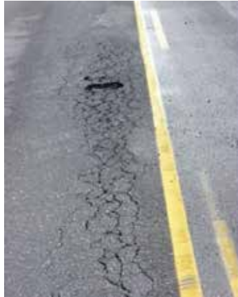
Figura 13: Falla tipo piel de cocodrilo con nivel de severidad alto.
