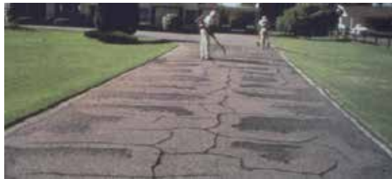
Figura 14: Falla tipo grieta de contracción.
