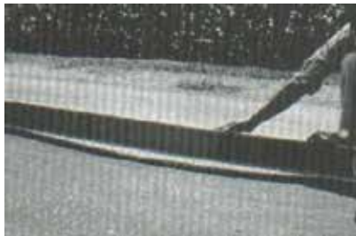
Figura 17: Falla tipo depresión, nivel de severidad alto.
