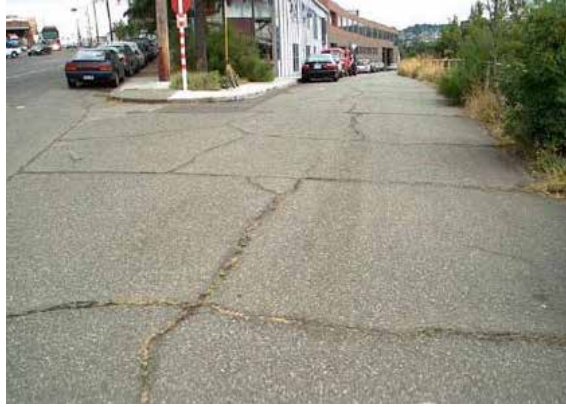
Figura 22: Falla tipo grietas de reflexión de juntas de losas de concreto, nivel de severidad alto.
