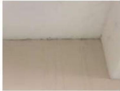
Figura 3: Humedad en paredes Fuente: Vargas (2022)
