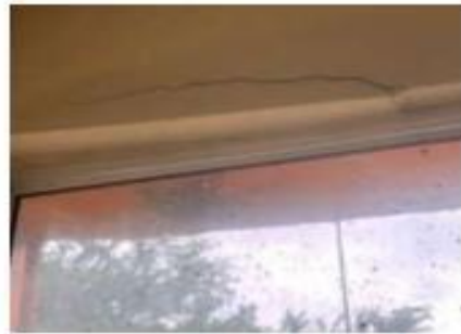
Figura 4: Deterioro en dinteles Fuente: Vargas (2022)
