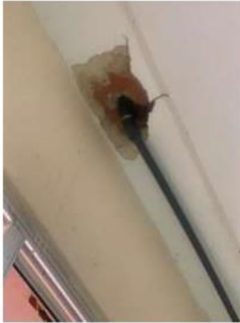
Figura 7: Perforación en Viga para instalación sanitaria. Fuente: Vargas (2022)
