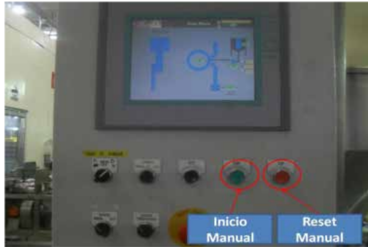
Figura 73: Vista del panel de la llenadora
