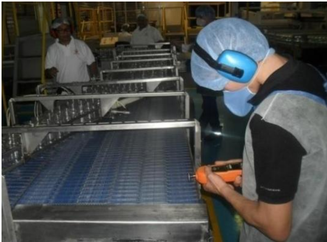
Figura 40: Medición de velocidades de la banda mediante un tacómetro. Fuente: Velásquez C. (2.020)
