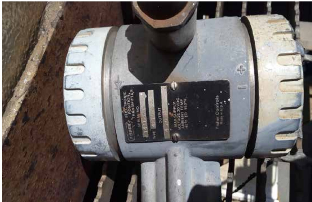
Figura 20. Transmisor de posición del damper de by-pass Fuente: Leon, A. (2019)
