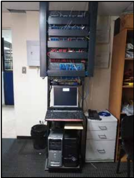
Figura 7. Rack de Servidor y Equipos
