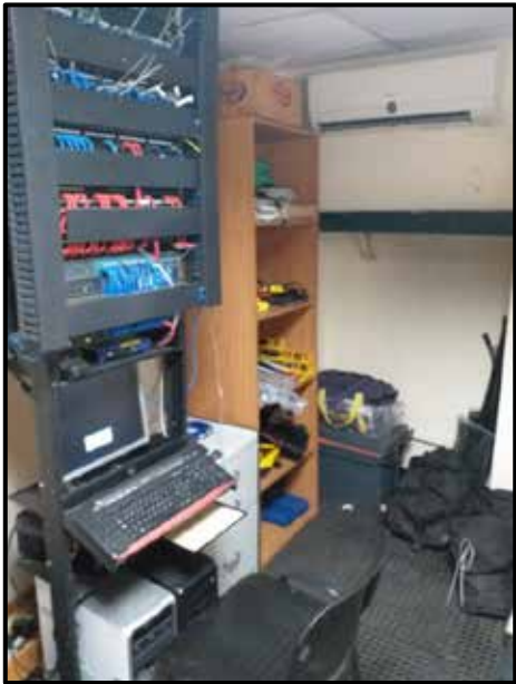
Figura 8. Cuarto de Servidor
