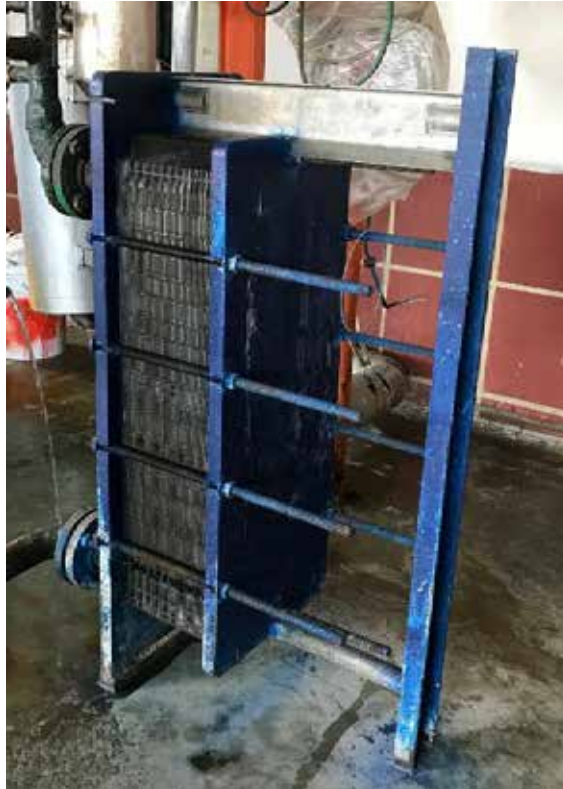
Figura 17: Intercambiador de calor
