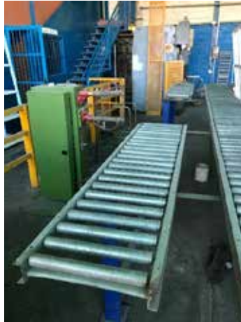
Figura 15: Transportador de rodillos en el área de soldadura de la panta Rubik Assembly C.A.
