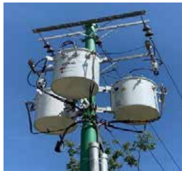
Figura 7. Transformadores Trifásicos de 100kVA
