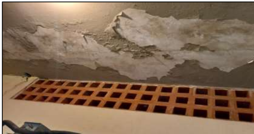
Figura 20: Daños en el techo debido a las filtraciones.
