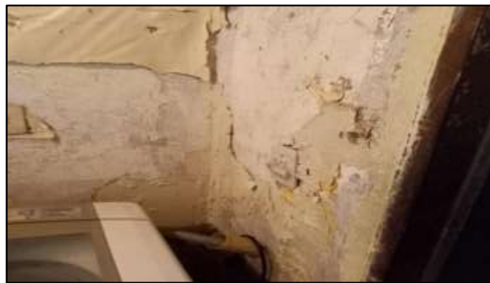
Figura 23: Daños en la pared, consecuencia de las filtraciones.
