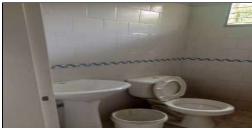
Figura 24: Abandono de los muebles sanitarios.
