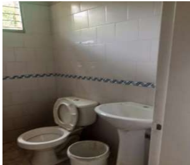
Baños de la Casa Hogar María Auxiliadora con problemas en las instalaciones. Moreno y Mejia (2022).
