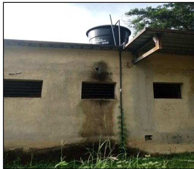
Abandono de obra del tanque elevado. Mejia y Moreno (2022).
