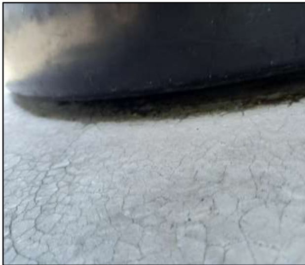
Filtración en el tanque elevado. Mejia y Moreno (2022).
