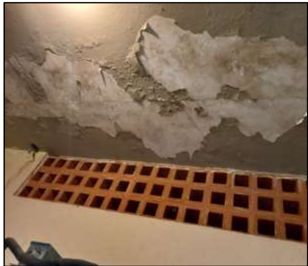
Daños en el techo debido a las filtraciones. Mejia y Moreno (2022).
