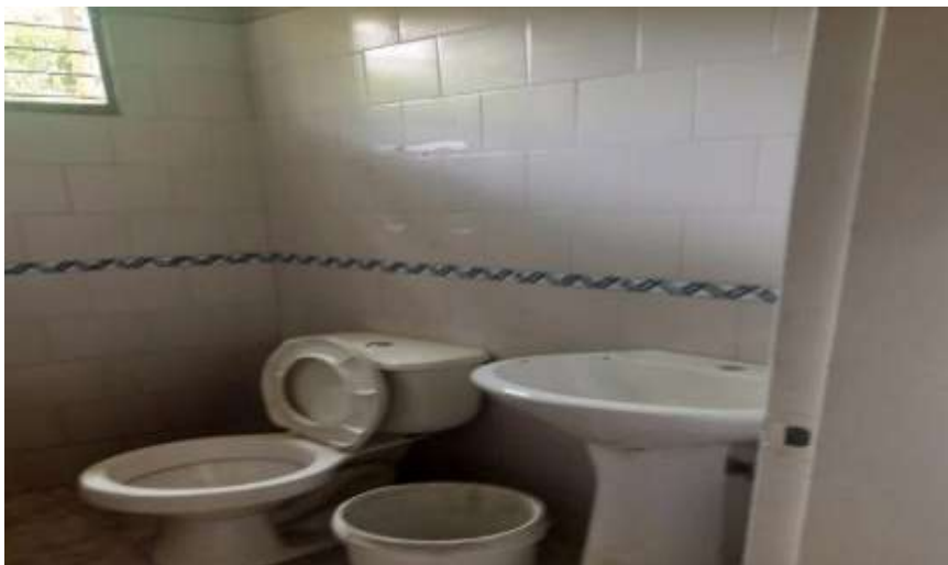
Figura 2: Baños de la Casa Hogar María Auxiliadora con problemas en las instalaciones.
