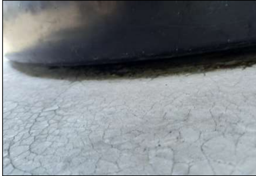
Figura 19: Filtración en el tanque elevado
