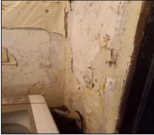
Daños en la pared, consecuencia de las filtraciones. Mejia y Moreno (2022).
