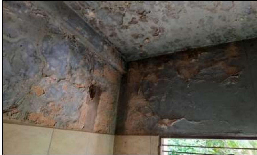
Figura 21: Daños en el techo y paredes debido a las filtraciones.
