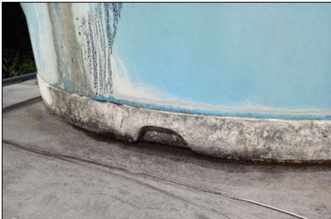
Figura 18: Filtración en el tanque elevado
