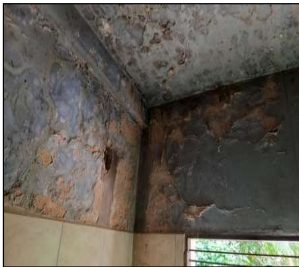
Daños en el techo y paredes debido a las filtraciones. Mejia y Moreno (2022).
