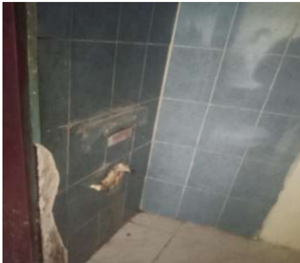
Baños de la Casa Hogar María Auxiliadora con problemas en las instalaciones. Moreno y Mejia (2022).
