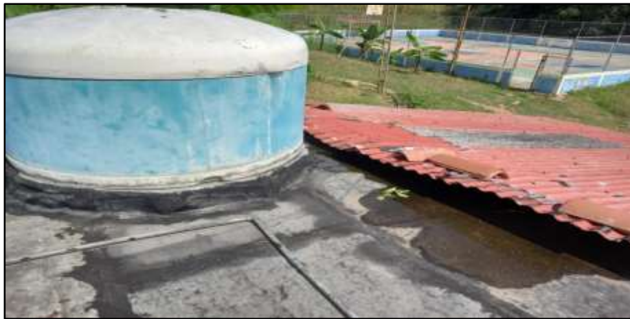
Figura 17: Filtración en el tanque elevado.
