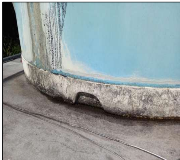
Filtración en el tanque elevado. Mejia y Moreno (2022).
