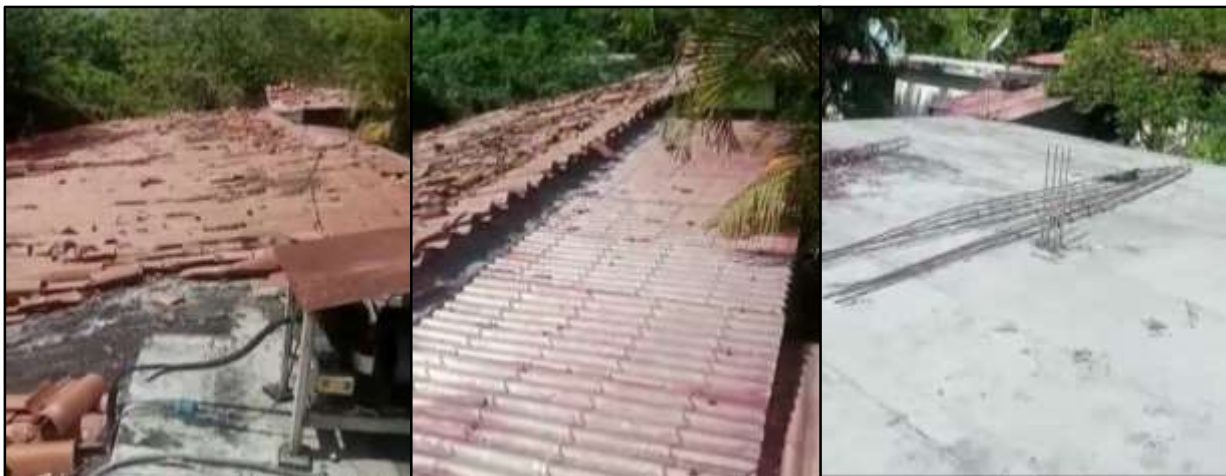
Figura 25: Situación de los techos de la Casa Hogar.
