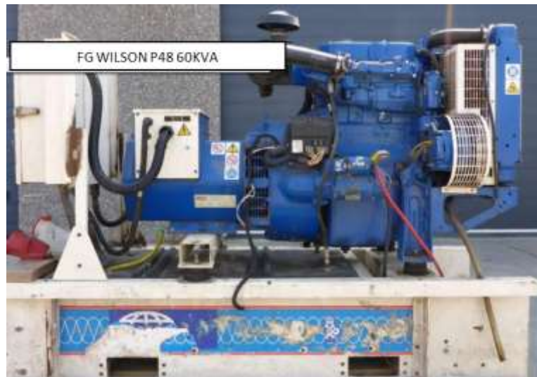
Figura 11: Planta eléctrica marca: FG Wilson, modelo: P44E; 48KW/60KVA Fuente: Autoría propia, 2017.
