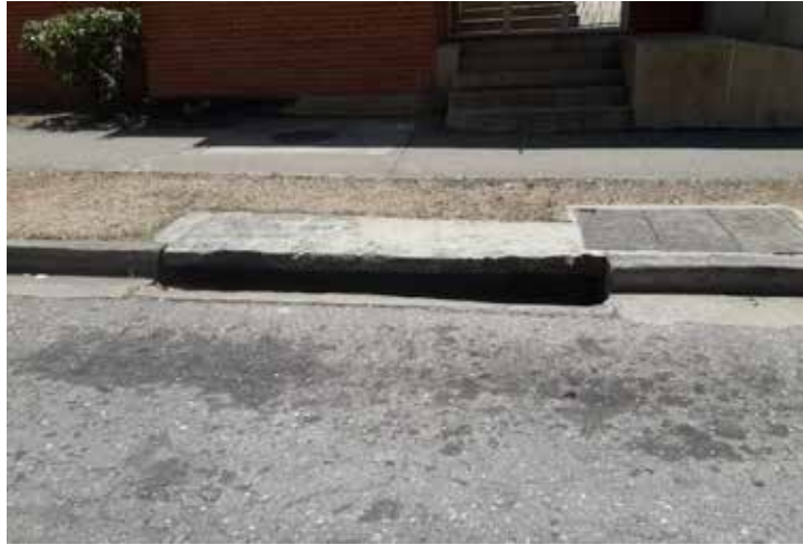
Figura 84: Deterioro del sistema hidráulico 2.
