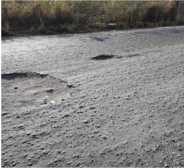
Figura 68: Disgregación y huecos
