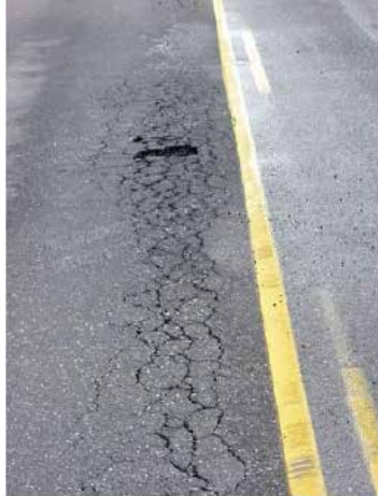
Figura 26: Grieta en forma de piel de cocodrilo
