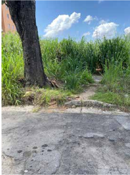
Figura 66: Falla de borde con piel de cocodrilo.
