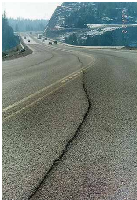
Figura 25: Ejemplo de las Grietas longitudinal.
