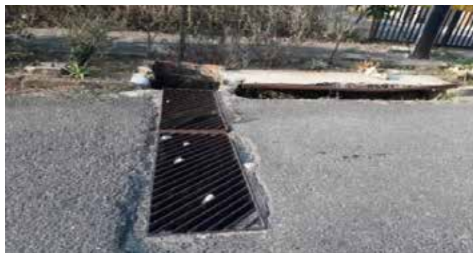
Figura 59: Cruce de sumideros de rejilla
