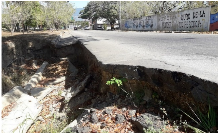
Figura 79: Falla de borde.
