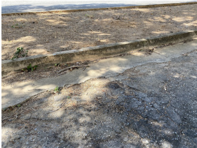
Figura 61: Falla de borde.
