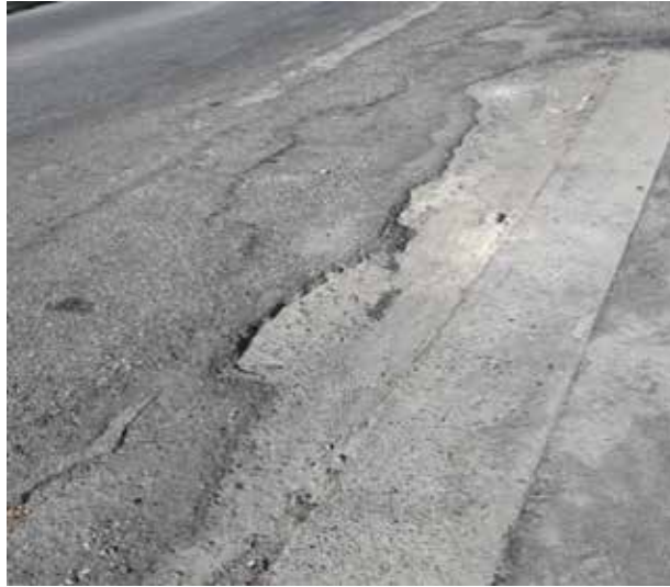
Figura 56: Falla de borde.
