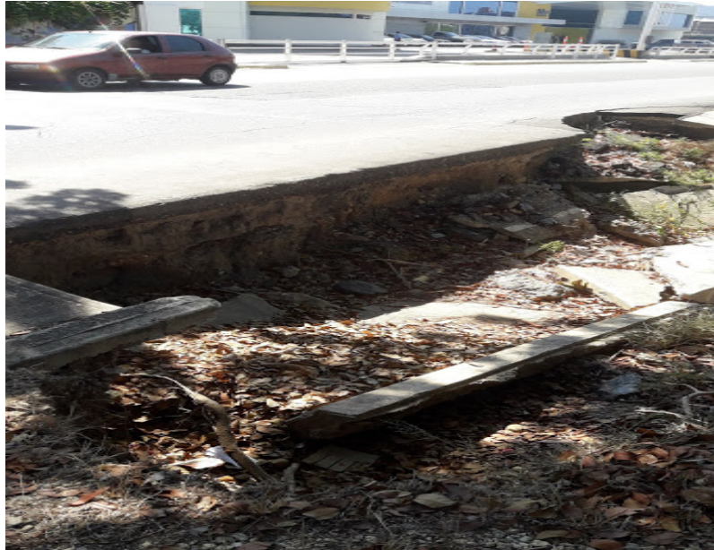
Figura 80: Falla de borde.
