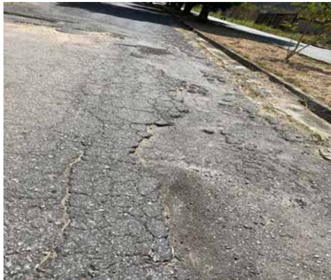
Figura 63: Grieta longitudinal con piel de cocodrilo.
