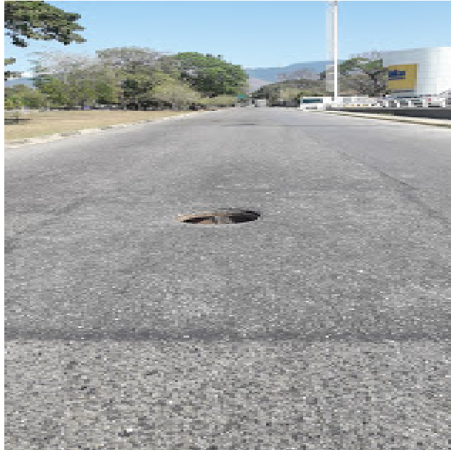
Figura 82: Hueco por tapa de tanquilla.
