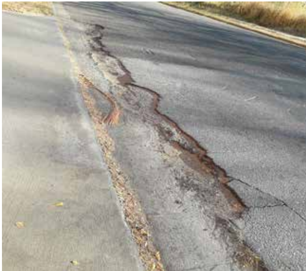
Figura 69: Falla de borde.
