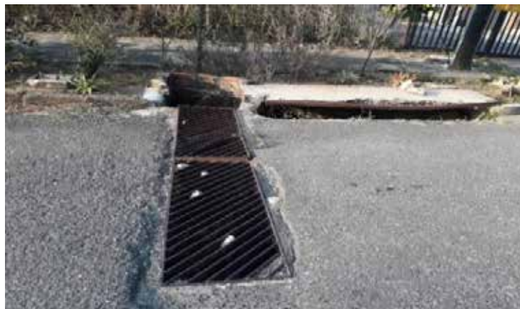
Figura 83: Deterioro del sistema hidráulico 1.
