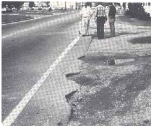
Figura 24: Ejemplo de las Grietas de borde.
