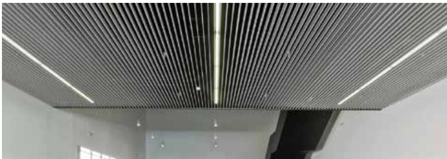
Figura 19: Cielo raso metálico. Fuente: https://www.mamport.es/cielo-metalico (2020).
