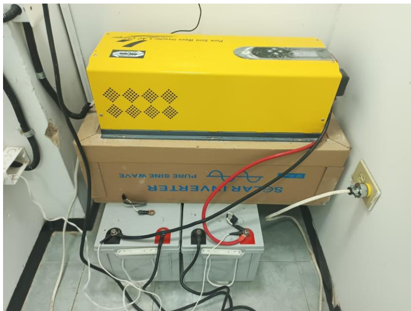
Figura 3. Sistema de respaldo de energía de la empresa Datcom Services.
