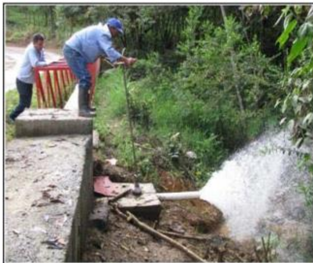
Figura 93. Válvula de limpieza en funcionamiento
