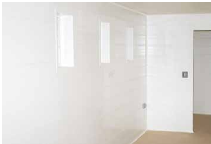
Figura 53: Acabado de paneles de PVC. Fuente: http://www.infhostel.com/tabiques-en-una-cocina-industrial/ (2017).
