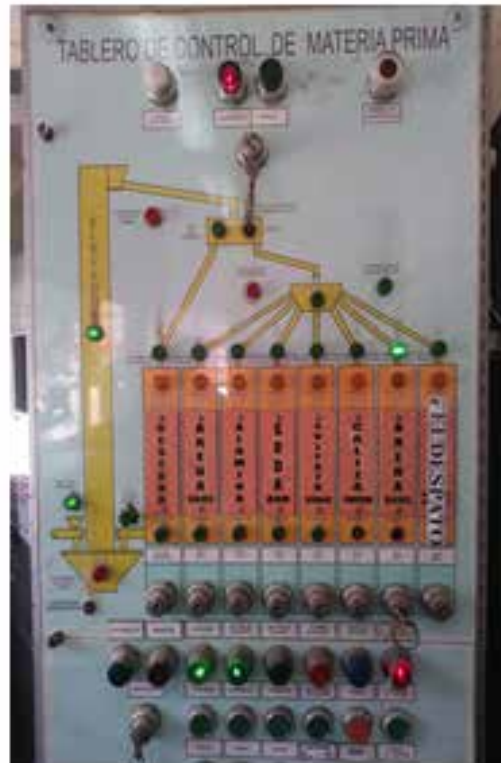
Anexo 2. Panel de Control
